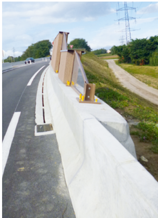
Photo 21 : Écran acoustique sur séparateur en béton de type « GBA élargie » (Source : Cerema)
