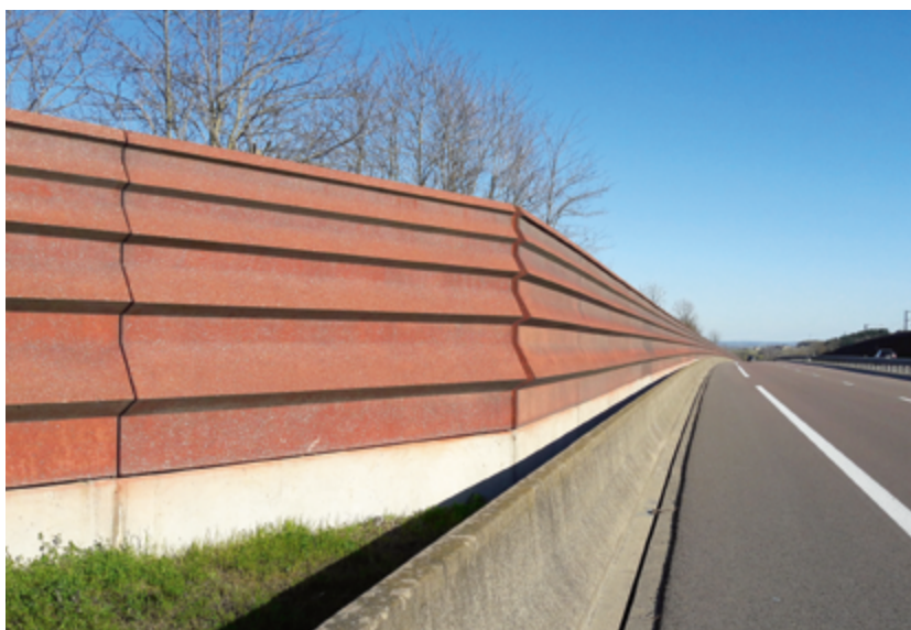
Photo 20 : Écran acoustique derrière une GBA (Source : Cerema)
