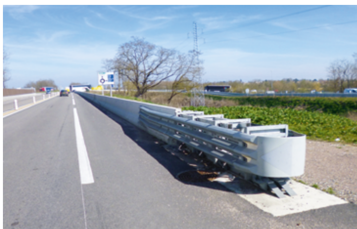
Photo 18 : Traitement d'une origine d'un ouvrage coulé en place par un atténuateur de choc (Source : Cerema)
