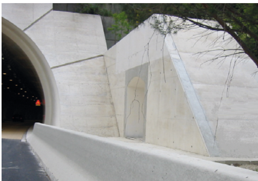
Photo 24 : Traitement du piédroit du tunnel sans interruption de la file de barrière de sécurité (Source : Cerema)
