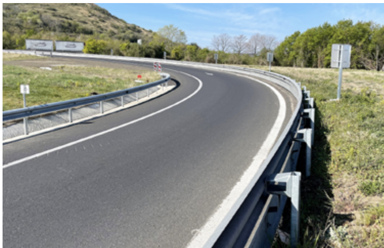
Photo 19 : Exemple de système de protection motocycliste (Source : Cerema)
