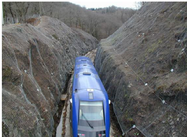
Grillage plaqué ancré (Crédit photo : SNCF)
