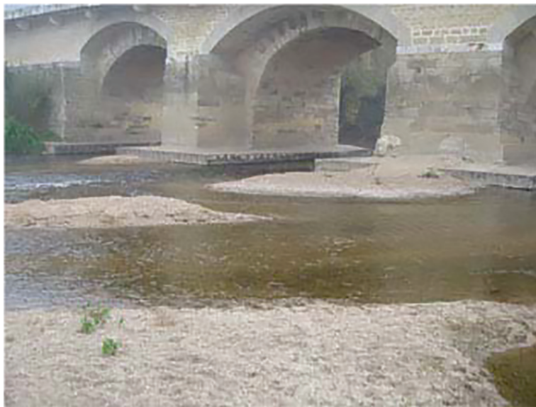
Figure 19 : Exemple de dépôts alluvionnaires et création de chenaux en tresse témoignant d'un remodelage du cours d'eau
