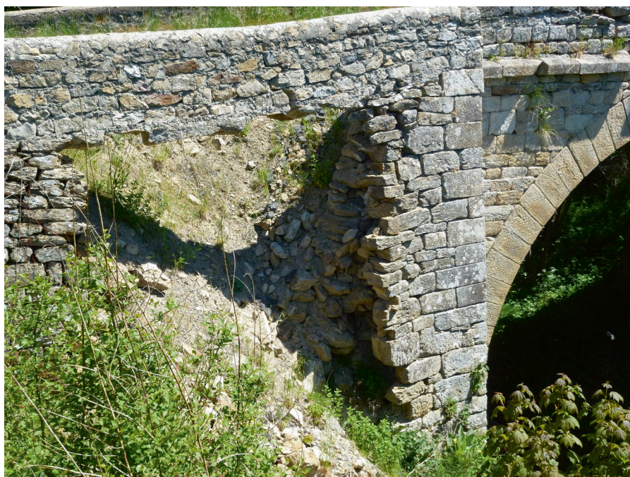
Figure 14 : Rupture du franchissement par effondrement d'un mur en retour
