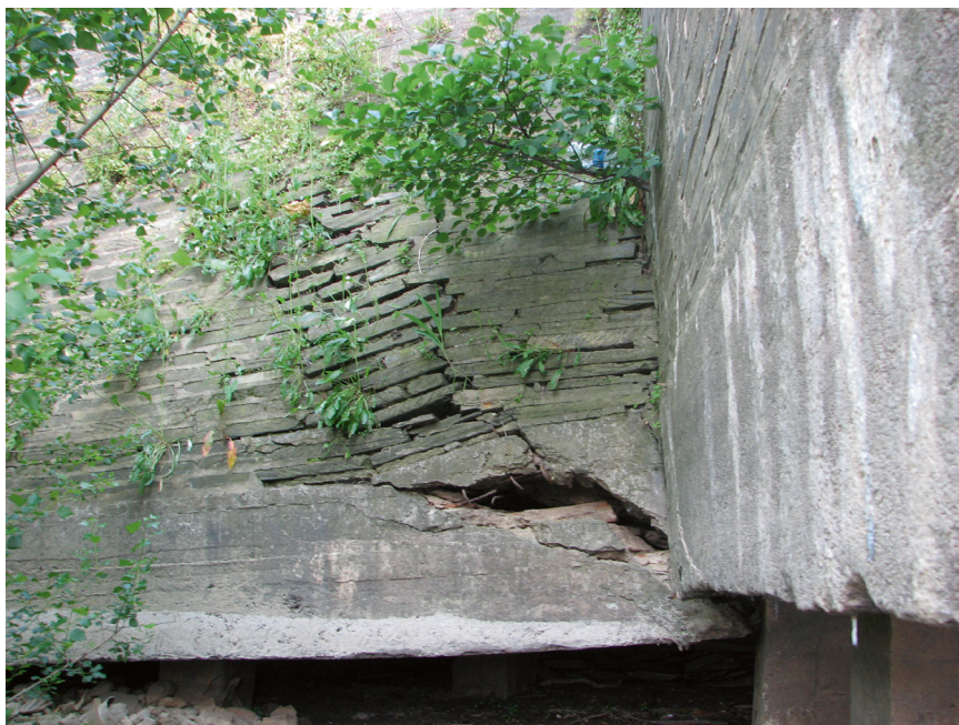
Figure 13 : Déstabilisation d'un ouvrage en maçonnerie du fait du développement de végétation arbustive
