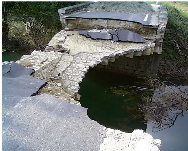
Figure 10 : Destruction d'un ouvrage maçonné lors d'une crue
