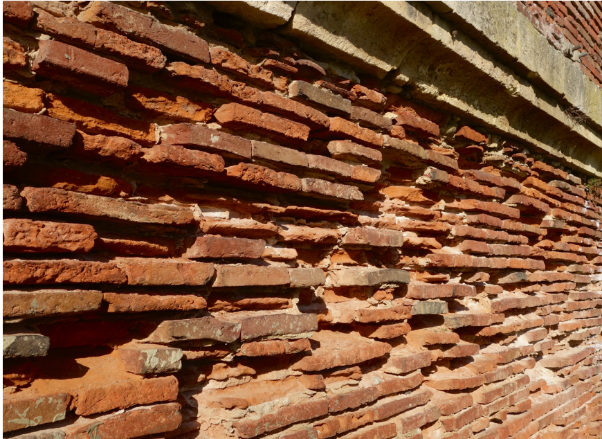
Figure 12 : Dégradation des matériaux du fait de la circulation d'eau et d'agents agressifs
