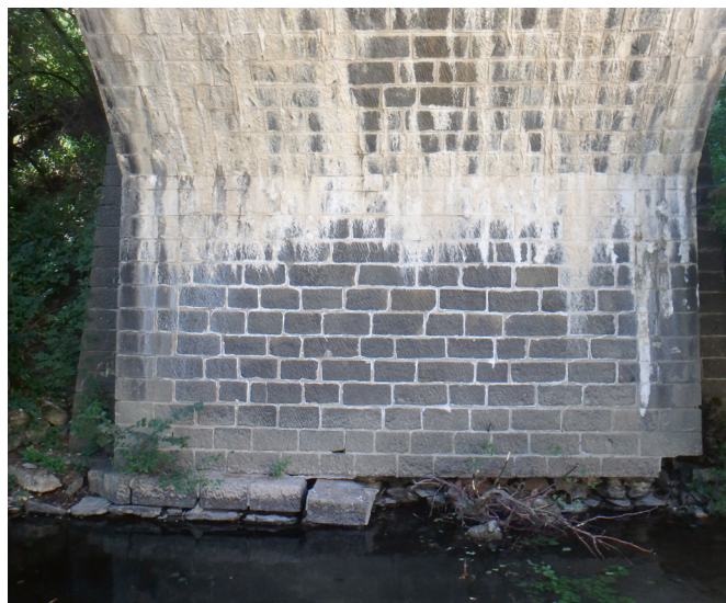
Figure 15 : Exemple d'affouillement sous la pile d'un ouvrage en maçonnerie
