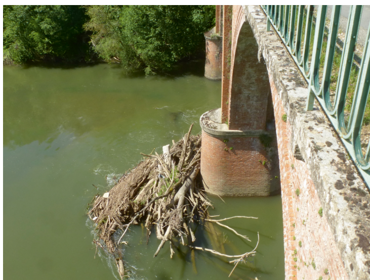
Figure 20 : Embâcles susceptibles de concentrer les charges lors d'une crue
