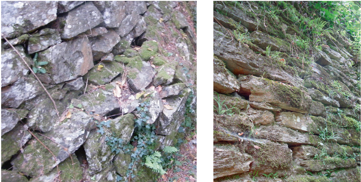
Figure 10 : Exemples d'actions de l'eau, de l'humidité et de la végétation
