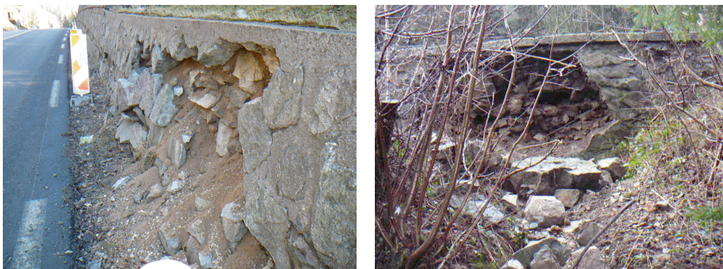
Figure 20 : Lacunes en blocs (départ de la maçonnerie de parement) ou formation de cavité dans la maçonnerie
