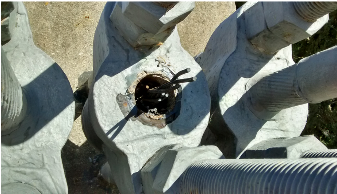
Illustration 4 : Rupture d'un câble élémentaire dans un culot d'ancrage
