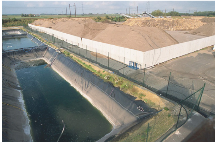
Figure 9 : Traitement biologique des sables de fonderie - Station Veolia à Chaingy (45) (Source : CTIF)
