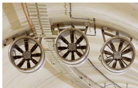
Photo 4 : Accélérateurs implantés en voûte (Source : © CETU)
