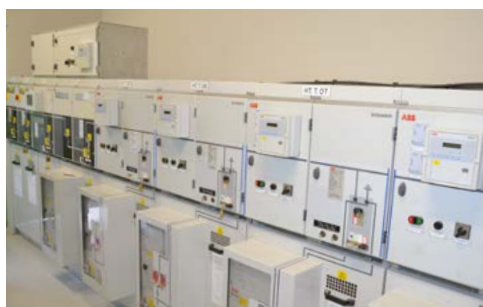
Photo 3 : Cellules de protection haute-tension (Source : © CETU)
