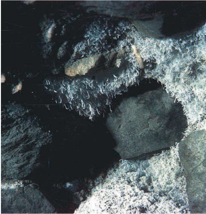
Figure 1 : efflorescences sur mortiers anciens à base de chaux
