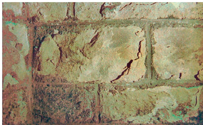
Figure 1 : moellons desquamés (la maçonnerie de moellons gréseux a subi un rejointoiement, déjà ancien, à l'aide d'un mortier riche en ciment et compact, qui a vraisemblablement accéléré, sinon initié le processus de desquamation, en déplaçant les transferts d'eau dans la pierre)
