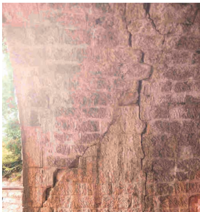
Figure 1 : fissure transversale couplée à une fissure oblique
