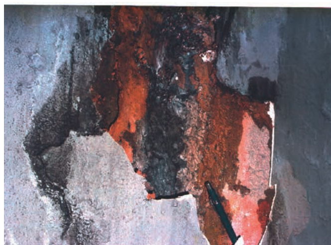
Figure 3 : éclatement d'un cuvelage sous l'effet du gel
