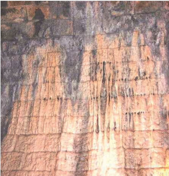
Figure 5 : concrétions de calcite sur maçonnerie de moellons
