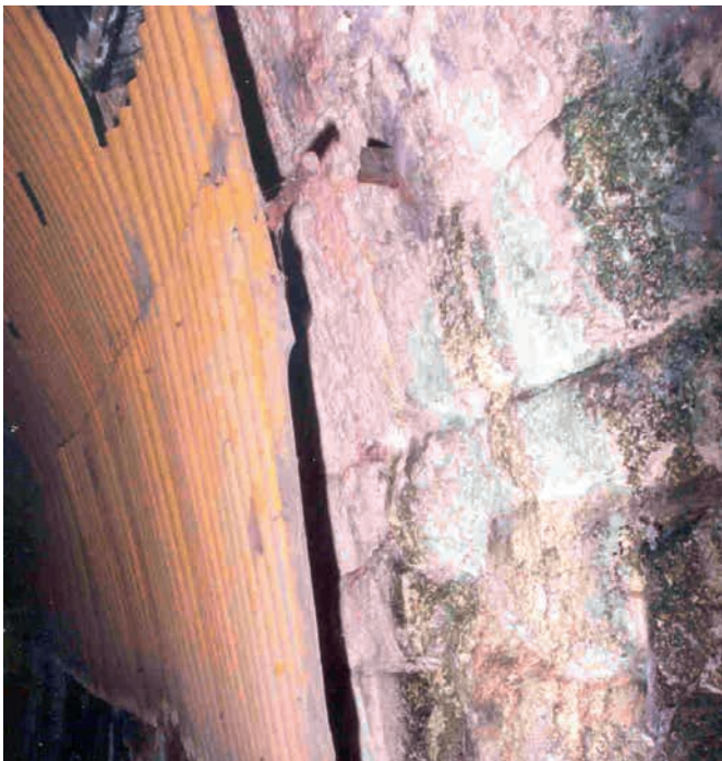
Figure 1 : perte d'un élément métallique et rupture des ancrages
