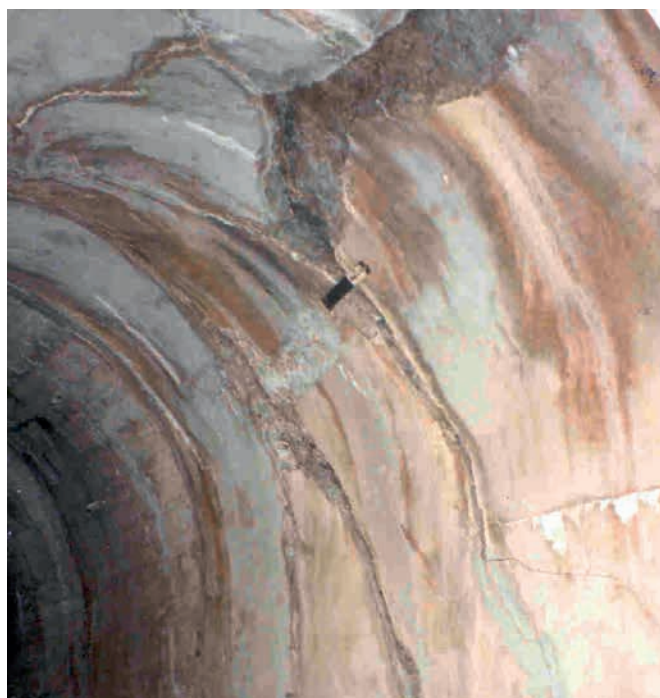
Figure 1 : réseau de fissures obliques dans une voûte en béton déformée par une poussée du terrain de couverture (un morceau de béton est déjà tombé par rupture en rein, un fissuromètre instrumente une fissure – le tunnel a dû être fermé quelques années plus tard)
