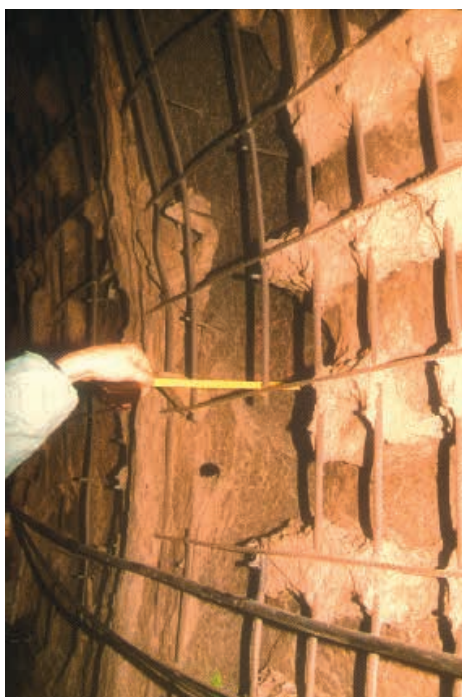
Figure 3 : écaillage profond ayant dégagé les armatures d'intrados [dans la zone la plus touchée, au cœur de l'incendie de 1996, la dégradation a localement atteint le mortier de bourrage], suite à l'incendie d'une navette de poids-lourds, pendant une dizaine d'heures, dans un tunnel formé de voussoirs préfabriqués en béton armé [tunnel sous la Manche]
