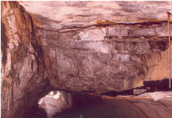
Figure 1 : bloc tombé sur les tôles indiquant l'affaiblissement de l'extrémité d'une strate calcaire (la présence de deux discontinuités verticales et humides sur les côtés constitue une situation potentiellement dangereuse à long terme pour l'ensemble de la partie rocheuse centrale.)
