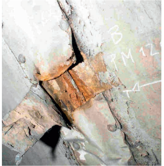
Figure 3 : pontage et joint amovible (ici joint PRT et pontage Hypalon) détruit par des frottements de poids lourds
