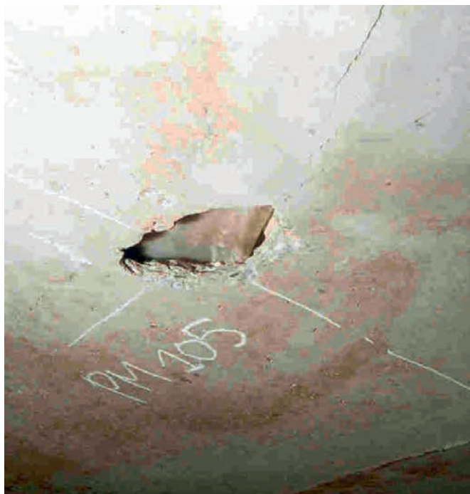
Figure 1 : repli de feuille (zone sonnante creux localement)
