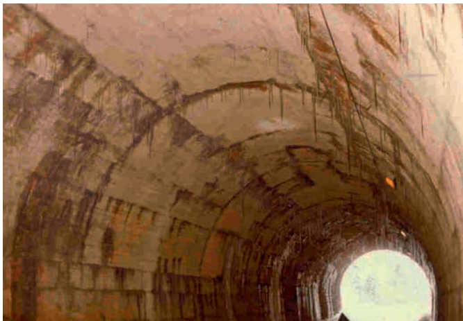
Figure 1 : nids de cailloux sur un revêtement en béton de 1936 [chaque montée de béton est soulignée par un alignement de nids de cailloux, perméable et parfaitement horizontal dû à un mauvais bétonnage]
