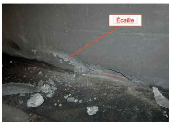
Figure 2 : éclatement du béton au droit du joint à la jonction entre le trottoir et le piédroit
