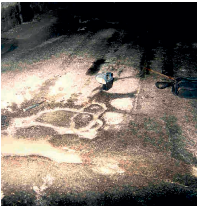
Figure 1 : faïençage et flaches [fondation saturée d'eau et comportant des zones de dissolution sous l'effet de pompage résultant du passage des véhicules]
