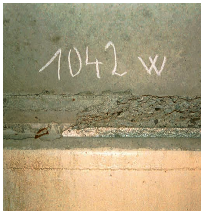
Figure 2 : épaufrure à la base de l'appui d'une dalle de ventilation, survenue probablement lors du décoffrage ; à gauche, subsiste une écaille non encore tombée.
