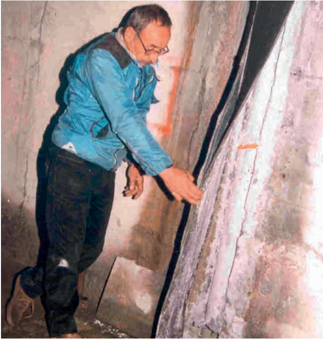
Figure 2 : pontage décollé (la base du captage est détruite par le gel et engorgée)
