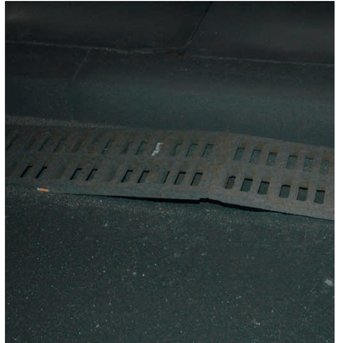
Figure 3 : grille mal positionnée et engorgement du caniveau
