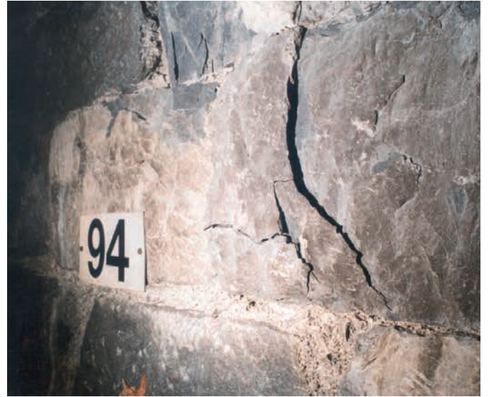
Figure 3 : écaillage de moellons en piédroit (l'écaille, décollée de 15 mm, n'est pas détachable à la main ; les moellons supérieurs et inférieurs sont en contact direct sans mortier)
