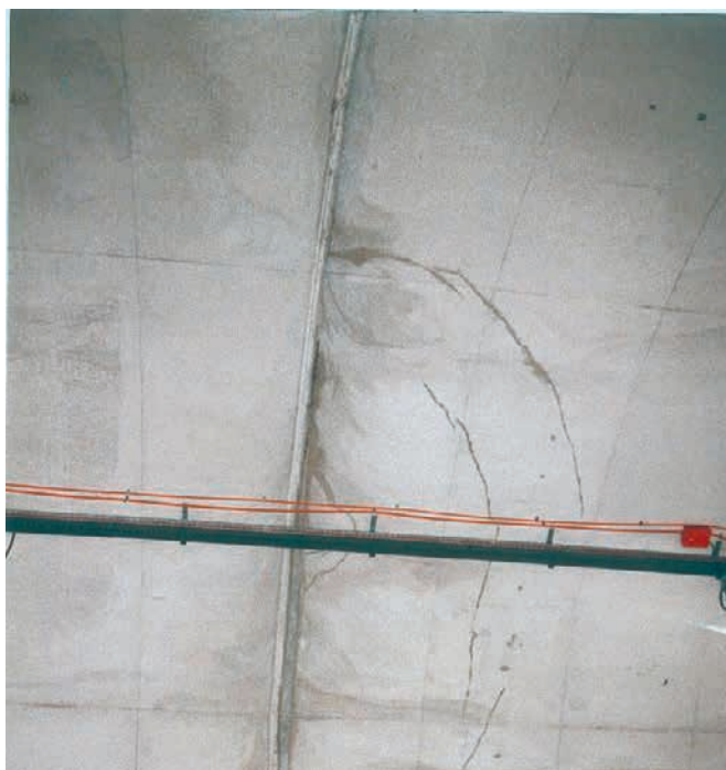
Figure 1 : lunules imbriquées en rein (la base de la photo correspond au trottoir ; le bétonnage s'est fait de la droite vers la gauche)
