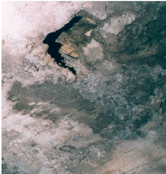
Figure 1 : vide d'origine à l'extrados d'un béton très altéré [le revêtement sonnait creux est instable autour de l'ouverture]
