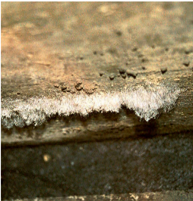
Figure 3 : efflorescences au ras du sol sur un béton de 1976
