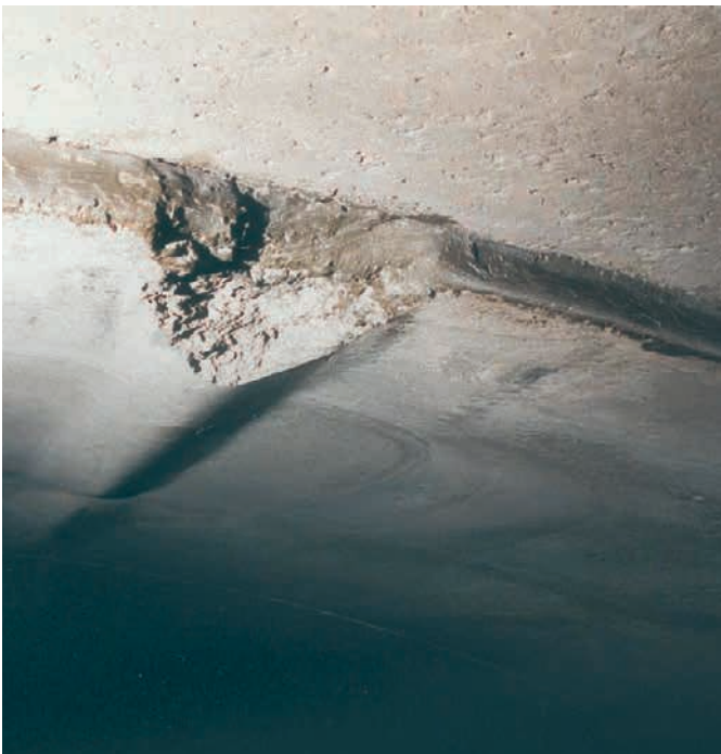
Figure 1 : déformation locale du coffrage
