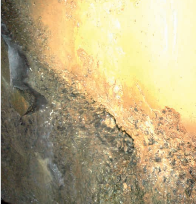
Figure 5 : éclatement du béton par le gel, en base de piédroit
