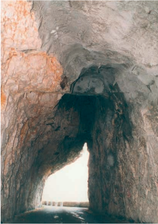
Figure 3 : instabilités résiduelles confortées par béton projeté dans la zone de l'alésage latéral
