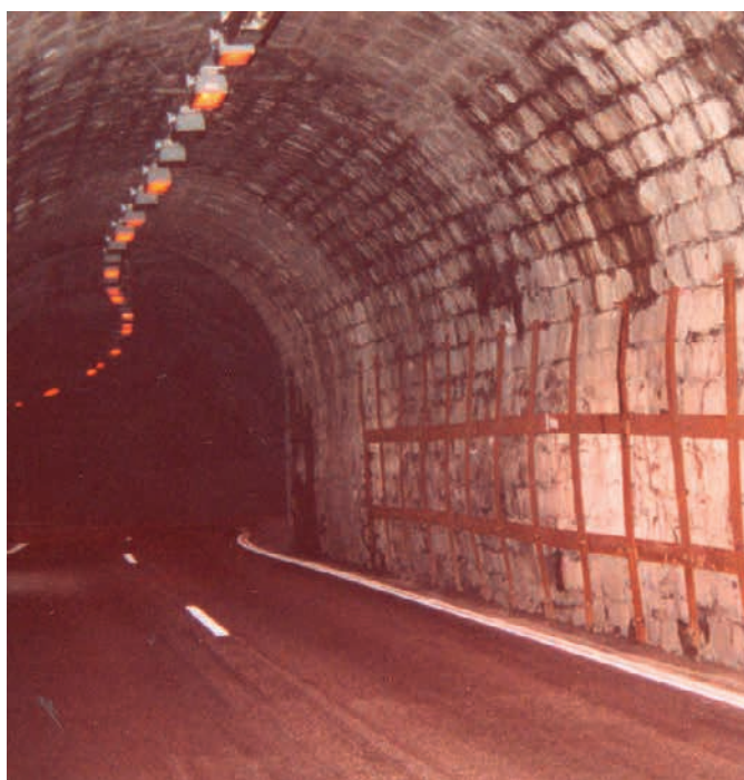
Figure 1 : ventre de piédroit, conforté par ancrages et larges plats
