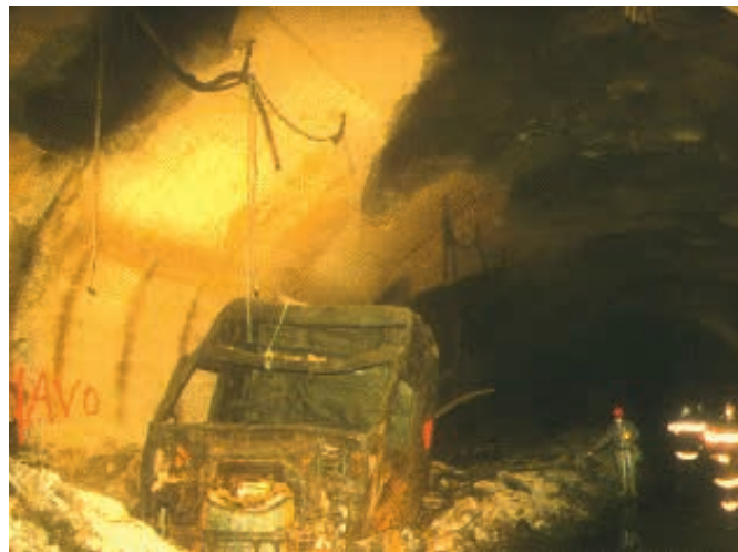
Figure 2 : cratères de 30 à 60 cm de profondeur creusés dans la voûte par l'incendie, au droit du poids-lourd à l'origine du feu [tunnel du Mont-Blanc]
