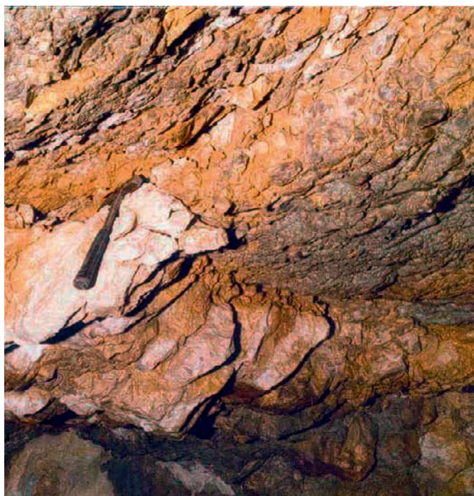
Figure 1 : masse de roche fracturée séparée du terrain par un joint argileux ou « pont de roche instable » (purge possible dans un premier temps)
