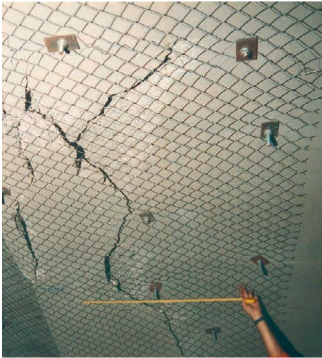
Figure 3 : rupture d'une voûte en béton coffré armé sous l'action de sollicitations trop élevées
