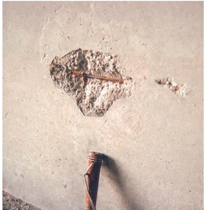
Figure 2 : éclatements dans un béton récent
