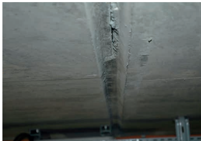
Figure 4 : désordres sur un joint sec [mouvement entre anneaux ou arrachement du béton au décoffrage]
