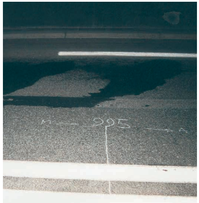
Figure 2 : remontée d'eau au travers du béton bitumineux
