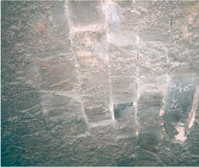
Figure 2 : écaillage de moellons en clé (les parties d'aspect lisse sont les cicatrices de départ des écailles dont l'épaisseur atteint 10 cm ; on remarque l'absence quasi-totale de mortier dans le sens longitudinal, ainsi qu'une écaille décollée toujours en place par coincement latéral)
