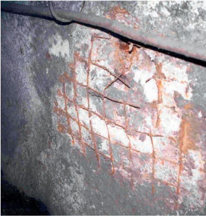
Figure 1 : enrobage insuffisant du treillis soudé (malfaçon)
