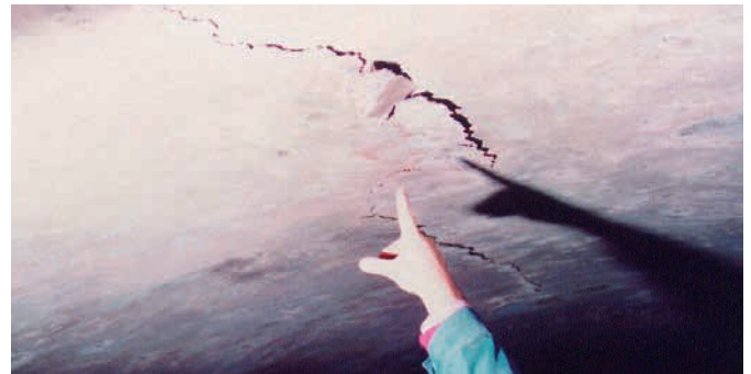
Figure 2 : début de cisaillement du béton en clé (la fissure de cisaillement est ici nettement exprimée ; la lèvre est fragile.)
