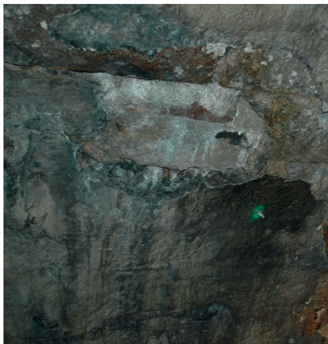
Figure 2 : enduit d'imperméabilisation dégradé suite à des venues d'eau (problèmes de mise en œuvre et effet du gel)
