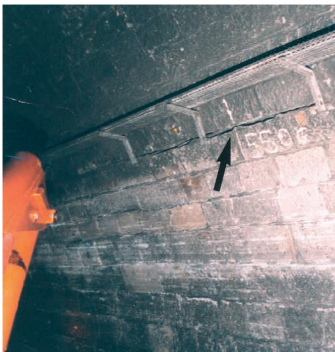
Figure 1 : fissure longitudinale consécutive à une déformation de la maçonnerie (méplat) attestée par les traces de frottement des véhicules (le mortier est toujours présent sur une lèvre de la fissure)
