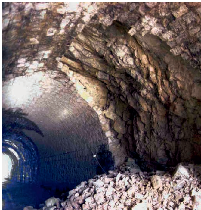
Figure 1 : moitié de voûte tombée par écrasement du piédroit, constitué de moellons très exfoliés et peu résistants (la ruine s'était annoncée par un ventre du piédroit, non conforté à temps ; le terrain n'est pas en cause)
