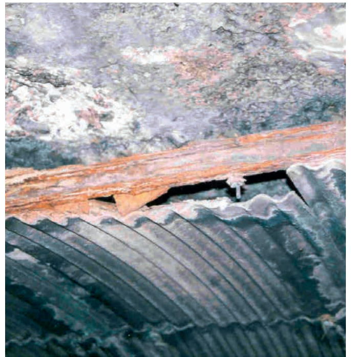
Figure 2 : panneaux en fibres-ciment (oxydation importante des lisses de soutien et rupture d'une fixation)
