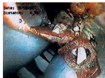
Figure 2 : exemples de caniveaux engorgés de débris de chantier (vidéo-endoscopie)
