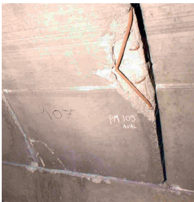
Figure 1 : élément préfabriqué mince épaufré par un choc (traces de frottements)
