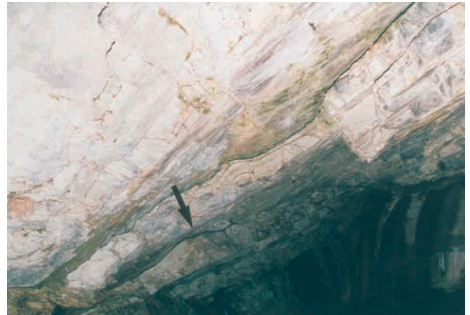
Figure 2 : plaques décollées inclinées de 45° en rein de tunnel
