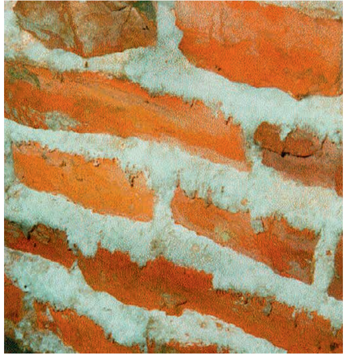
Figure 2 : efflorescences sur mortiers anciens à base de chaux
