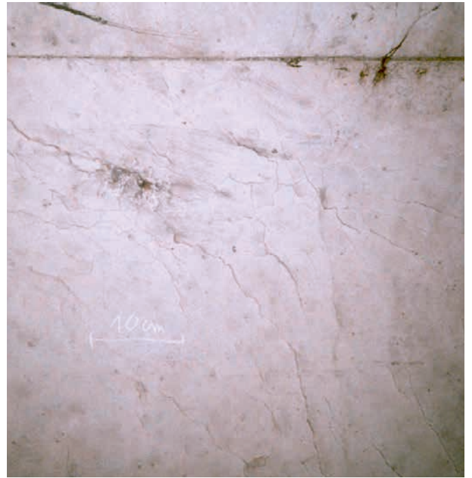
Figure 4 : réseau de fissures de peau
