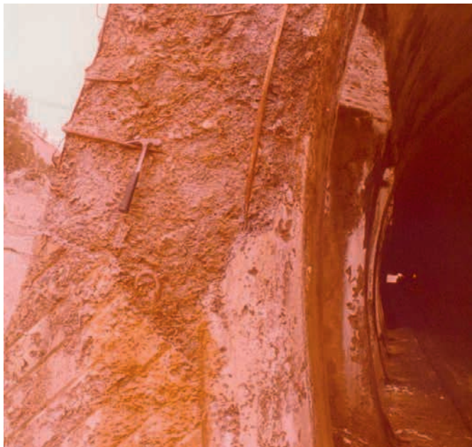
Figure 4 : piédroit en béton armé gelé
