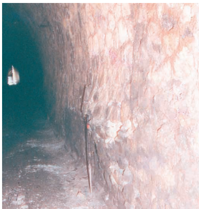
Figure 2 : ventre de piédroit proche de la ruine (maçonnerie très altérée)
