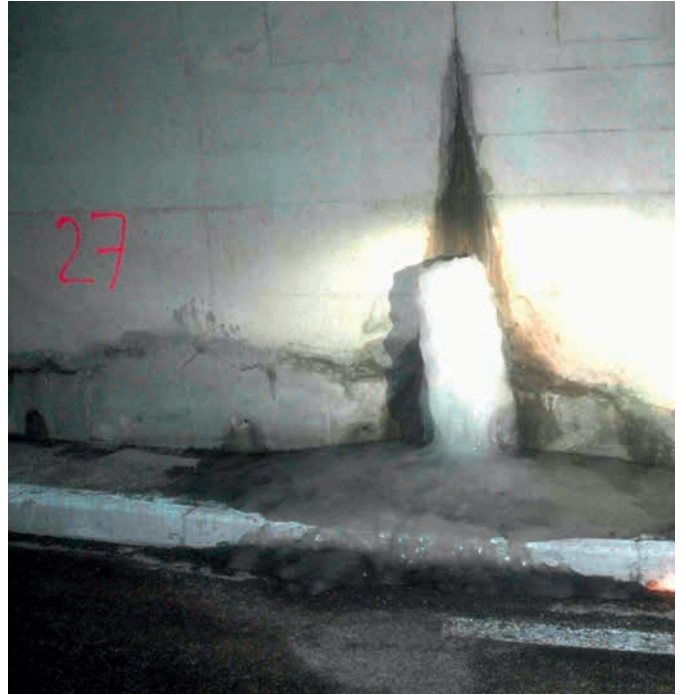
Figure 6 : amas de glace sur trottoir provenant d'un joint
