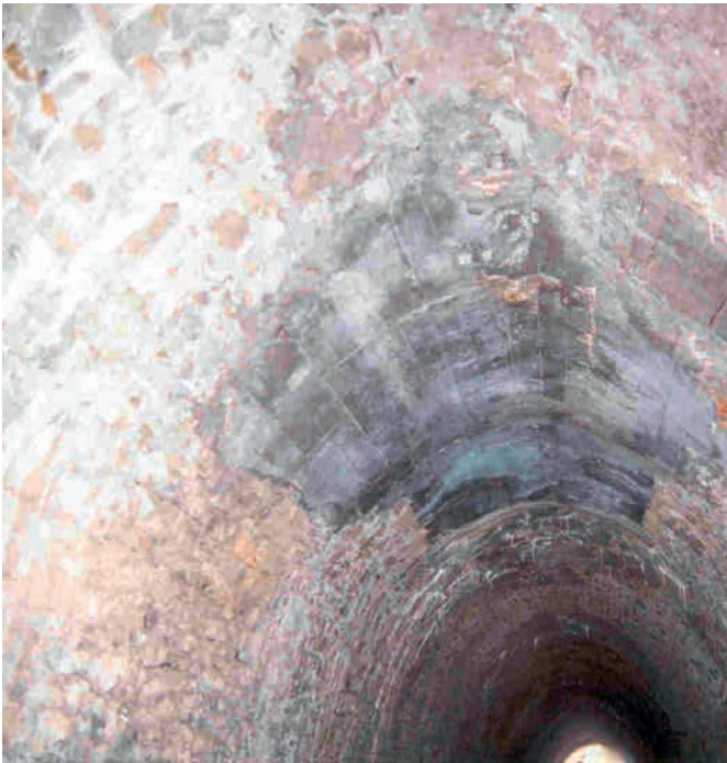
Figure 3 : pincement de clé (déjà réparé en partie avec du béton coffré non armé, il se poursuit par écrasement des moellons de clé restants et du béton)
