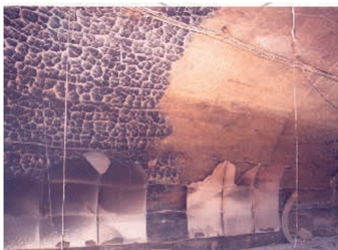
Figure 1 : béton faïencé [limite thermique nette marquée par le dépôt ou non de la suie sur le faïençage], à une distance de 120 m du poids-lourd à l'origine du feu [sans autre véhicule], dans le tunnel du Mont-Blanc
