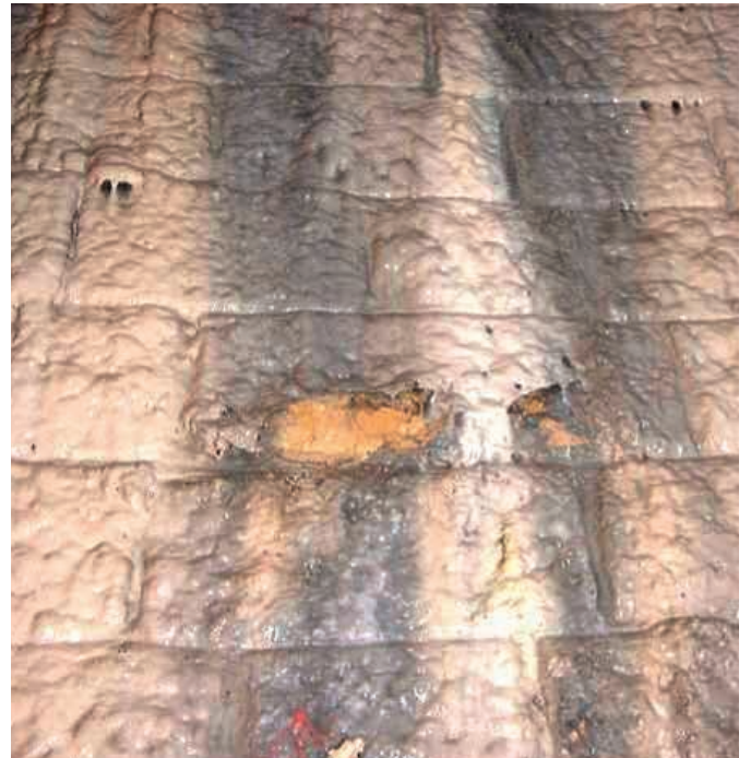
Figure 6 : concrétions encroûtantes de calcite sur maçonnerie de moellons
