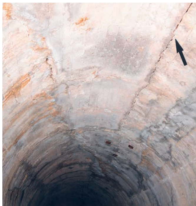
Figure 2 : fissure longitudinale en béton coffré liée à une déformation du revêtement sous la poussée du terrain encaissant (la fissure s'exprime le long d'une reprise de bétonnage)
