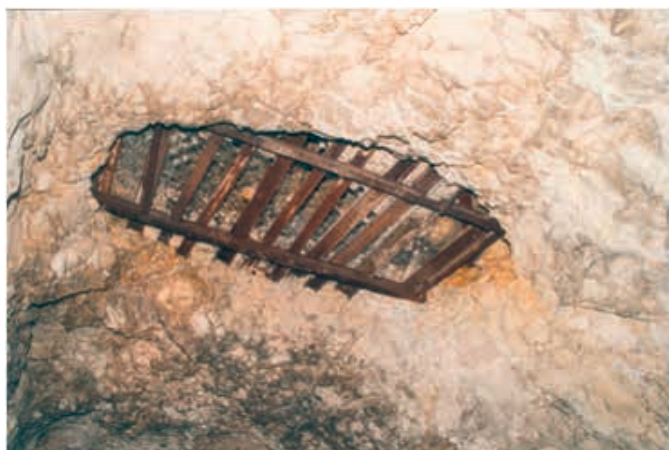
Figure 1 : karst rempli de matériaux mal consolidés et protection contre les chutes de matériaux par profilés métalliques
