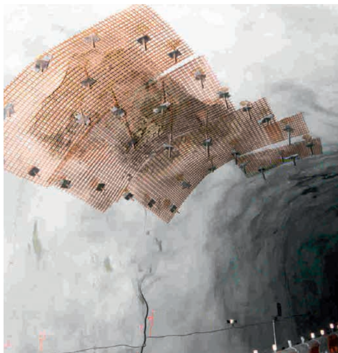
Figure 2 : gonflement de marnes ayant rompu un revêtement en béton projeté sans treillis soudé (réparation en cours)
