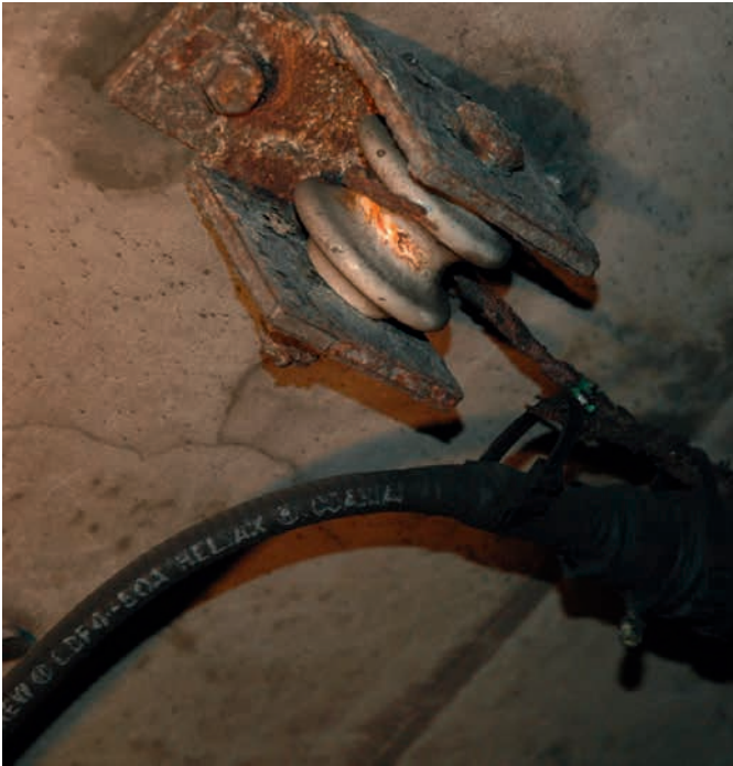
Figure 2c : attache plastique d'un câble d'alimentation cassée en calotte
