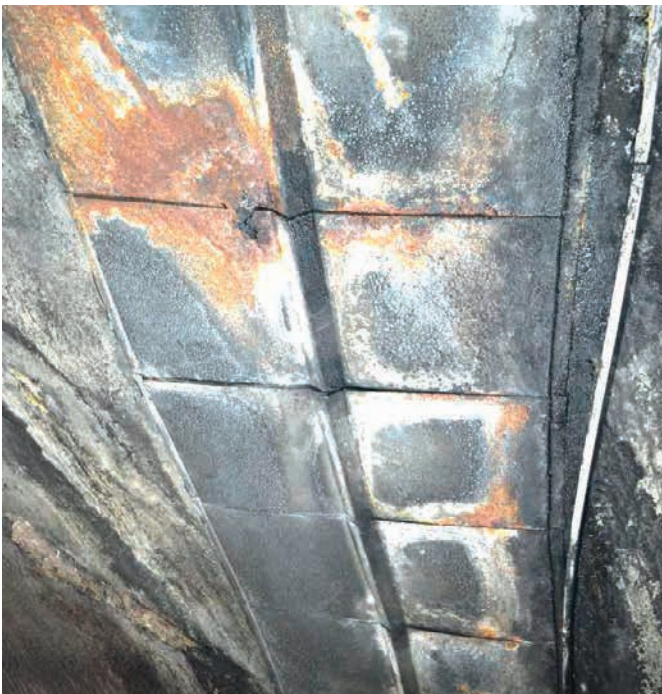
Figure 4 : drain d'intrados en acier zingué, corrodé et fuyant
