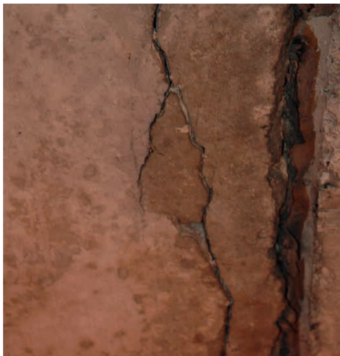
Figure 1 : désordres sur un joint en élastomère
