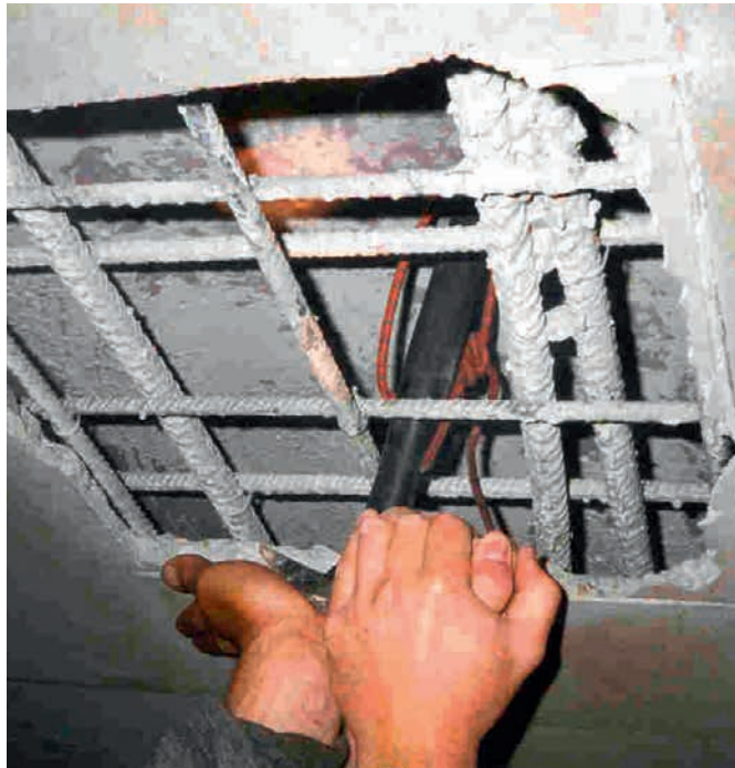
Figure 2 : fenêtre de reconnaissance ouverte sur une zone sonnante fortement le creux [vide extradors de 27 cm par défaut de bétonnage]
