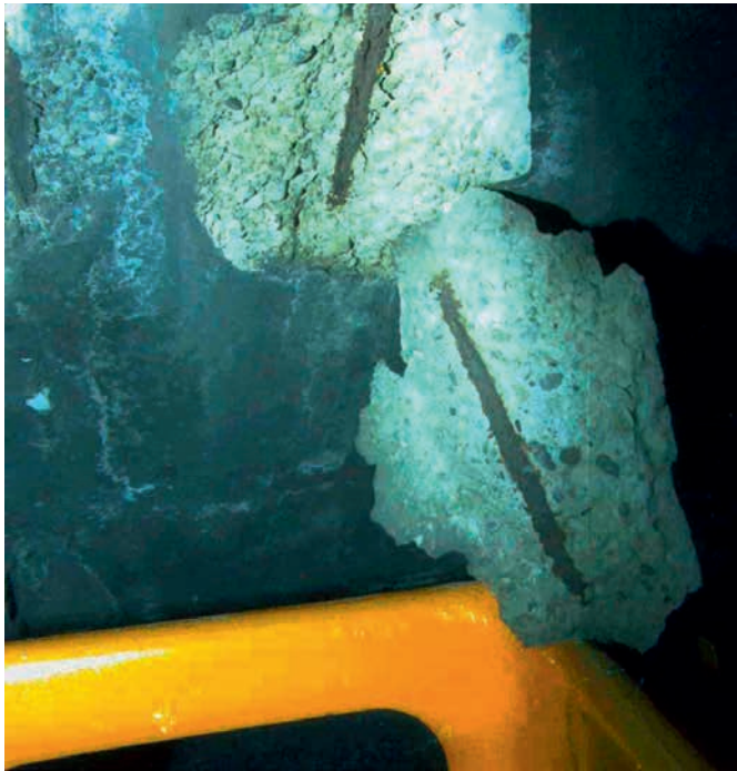
Figure 1 : écaille de 2 à 3 cm d'épaisseur suite à la corrosion d'une armature (béton de 1963)
