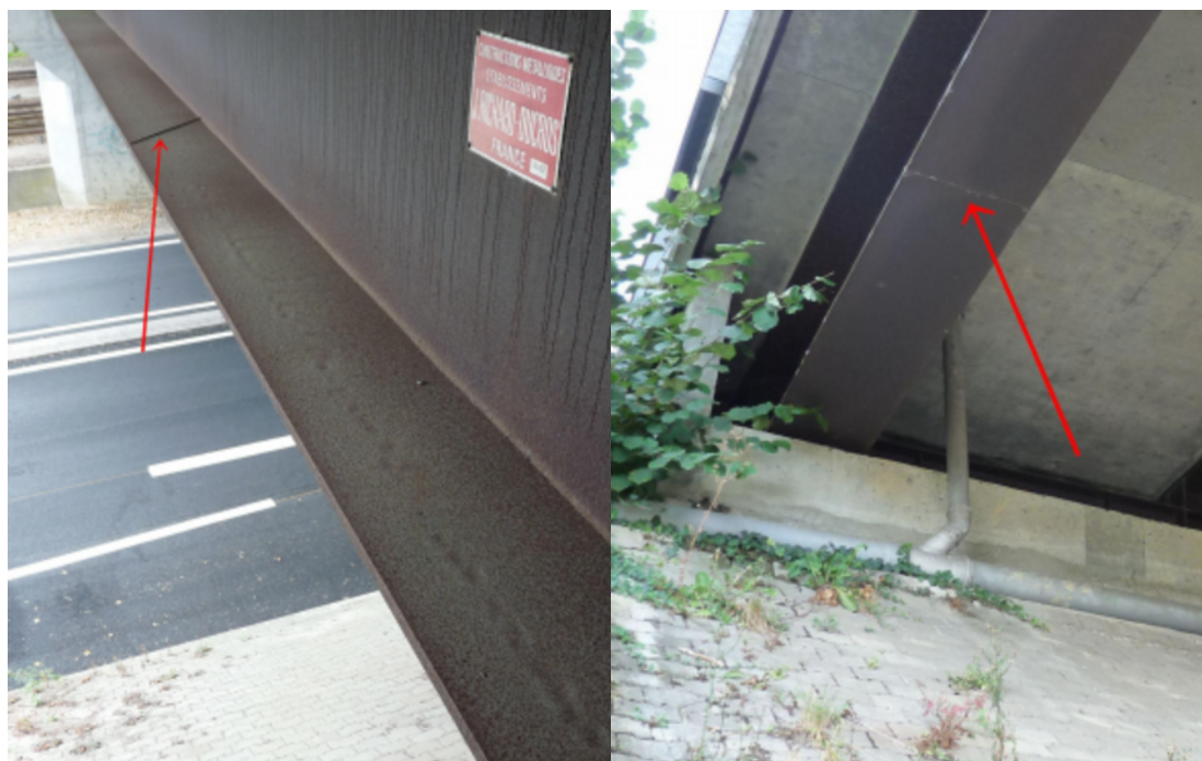
Figure 8 - Cordons de soudure anti-ruissellement (Source : IFSTTAR)
