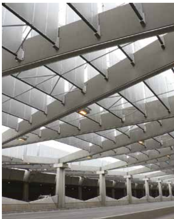
Figure 7. Exemple d'une structure de type damier phonique (autoroute A86 à Vélizy-Villacoublay, 78)
