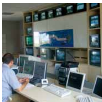
Figure 29 : Équipement de gestion : moniteurs et consoles de supervision
