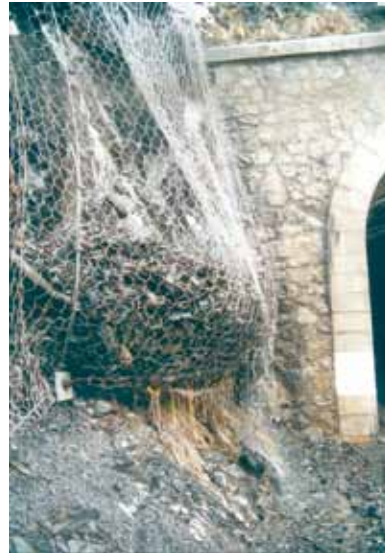
Figure 17 : Grillage de protection à purger
