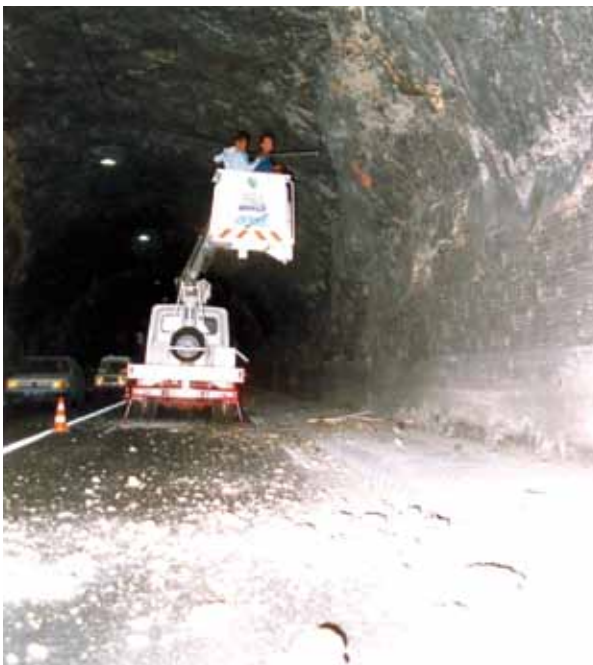
Figure 20 : Conditions de sécurité insuffisantes lors d'une opération de purge manuelle dans un tunnel en exploitation
