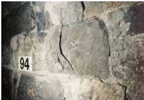
Écaillage mécanique de moellons
