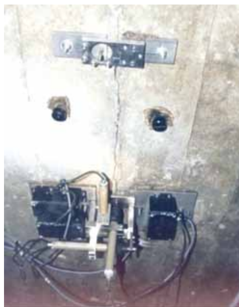
Figure 3 : Évolution d'un dispositif de surveillance : extensomètre à base courte (au centre), fissuromètre tridimensionnel manuel (en haut), fissuromètre automatique (en bas) permettant la télésurveillance
