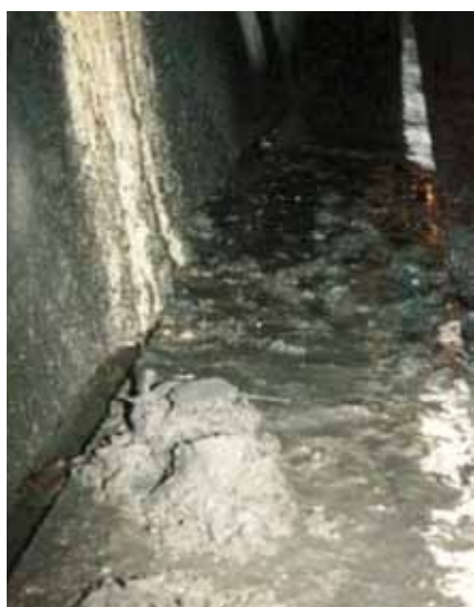
Figure 10 : Conséquence du manque d'entretien : cunette engorgée
