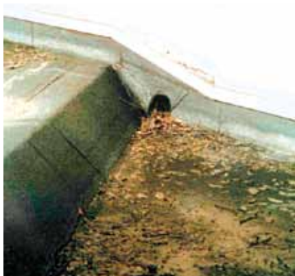
Figure 26 : Risque d'obturation du conduit d'évacuation sur la couverture de surface
