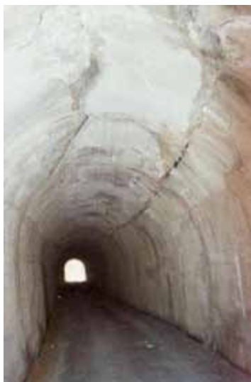
Fissures longitudinales ouvertes
