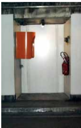
Figure 30 : Extincteurs dans une niche de sécurité
