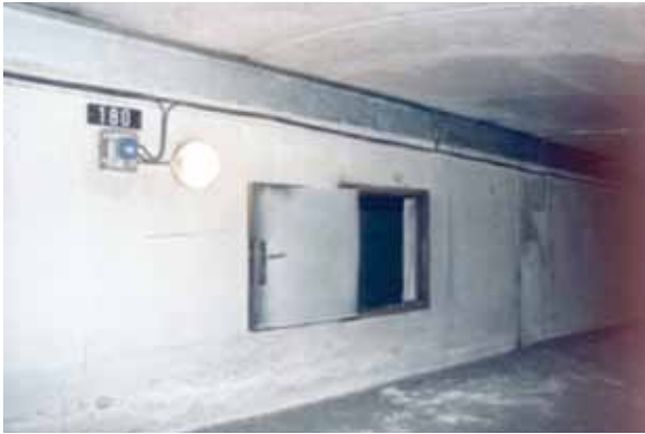
Figure 1 : Plaque de marquage décimétrique en gaine de ventilation
