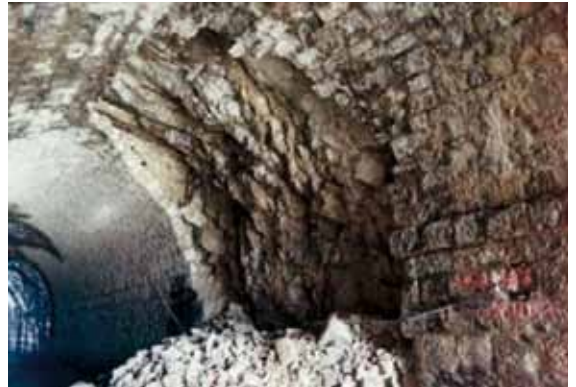
Effondrement de maçonnerie
