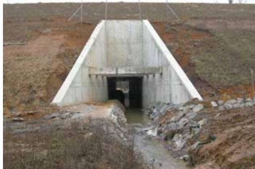
Photographie 16 : Murs en aile et « butons » pour réduire la longueur de couverture : diminution de longueur de couverture de 30 m (65 m au lieu des 95 m initiaux, surcoût de 6,3%).
