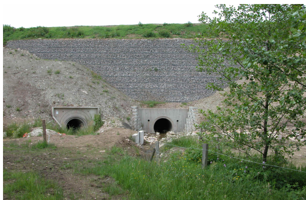
Photographie 17 : Mur en gabions pour soutenir le remblai et réduire la longueur de couverture
