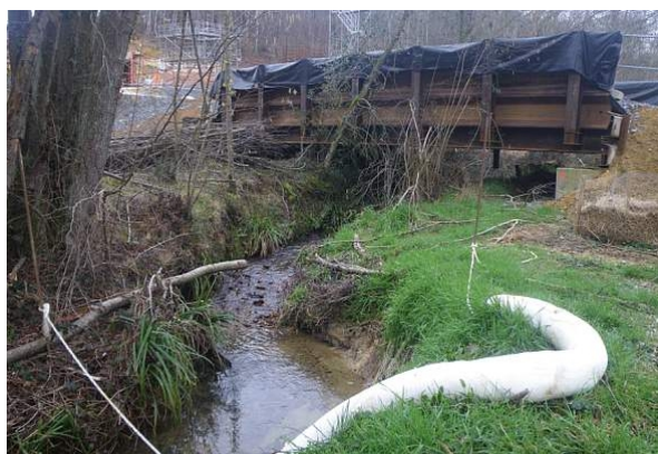
Photographie 6 : exemple de pont provisoire mis en place en phase chantier, préservant le lit mineur et les berges du cours d'eau (source : Onema, Délégation Interrégionale Sud Ouest).
