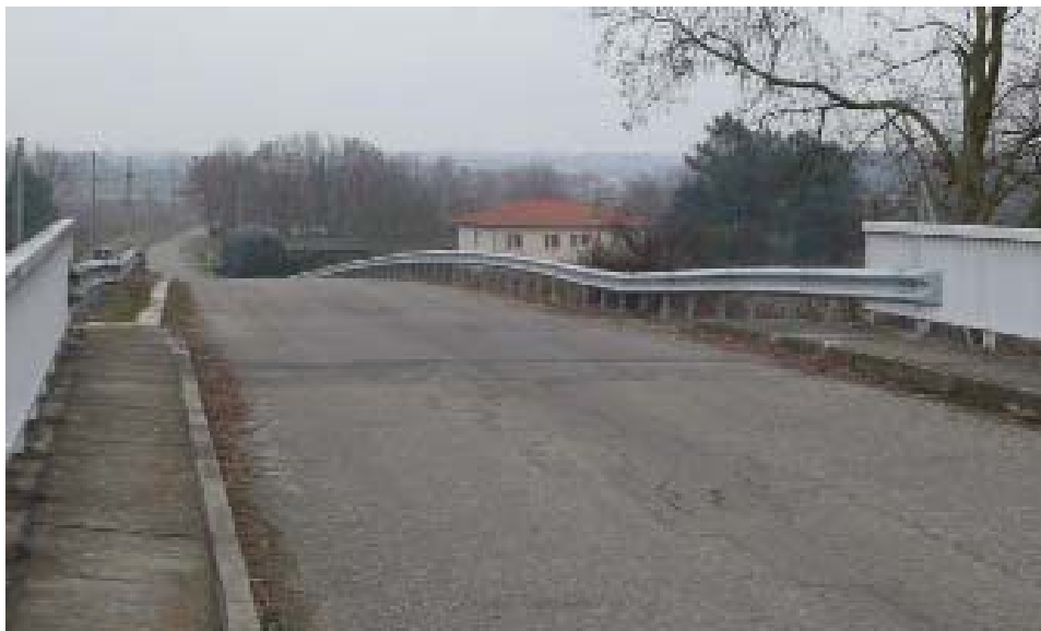
Photo 2 - Affaissement d'un remblai contigu marqué par la déformation des barrières de sécurité (crédit : LR Toulouse)
