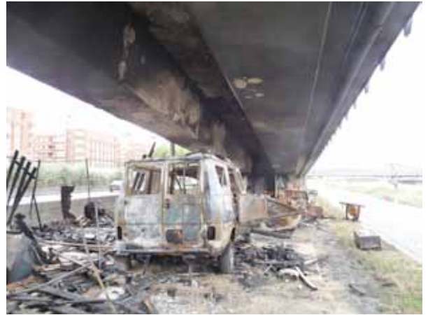
Figure 9 - Cas d'un ouvrage dans état douteux suite à un incendie déclaré sous le tablier (Photo : DIR Ile-de-France)
