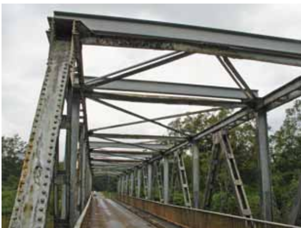
Figure 6 - Cas d'un ouvrage en état quasi normal : pont métallique présentant un enrrouillage et nécessitant une remise en peinture (Photo : Sétra)
