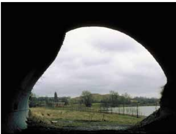
Figure 1 - Buse métallique présentant une déformation mettant en jeu la sécurité de l'ouvrage (Photo : Sétra)
