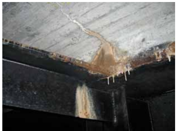
Figure 2 - Pont mixte présentant des traces d'humidité et des efflorescences pouvant faire craindre une corrosion des aciers passifs (Photo : Sétra)
