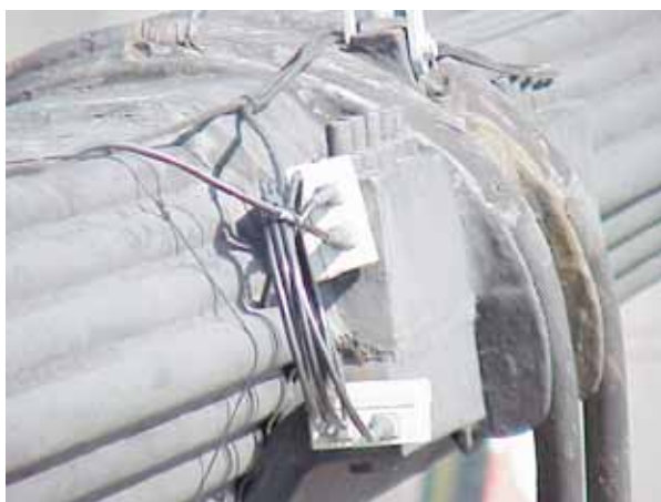
Figure 15 - Instrumentation d'un collier d'un câble du pont d'Aquitaine (Photo : LRCP de Bordeaux)
