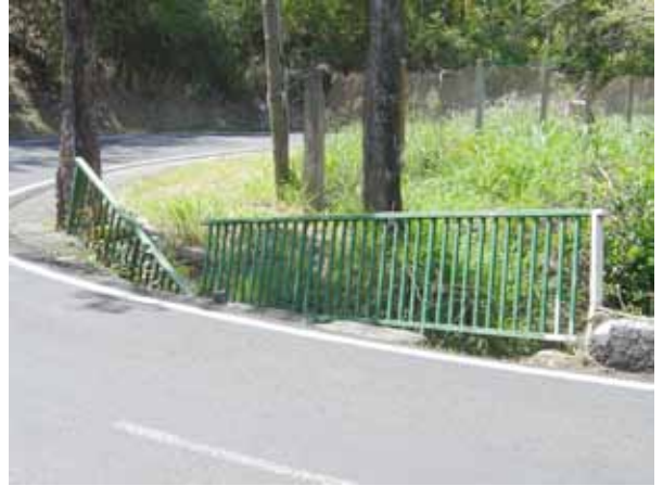
Figure 5 - Ouvrage présentant des risques pour la sécurité immédiate des usagers (Photo : Sêtra/G. Lacoste)
