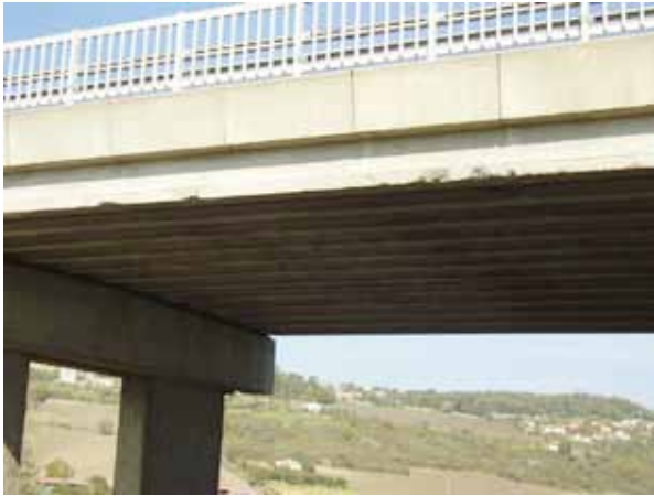
Figure 8 - Cas d'un ouvrage dans état douteux : un choc a endommagé la poutre de rive d'un ouvrage de type PRAD (Photo : DIR Massif-Central)
