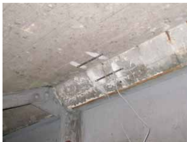
Figure 16 - Suivi d'ouverture de fissures à l'aide de capteurs de déplacements (Photo : CETE de l'Est)
