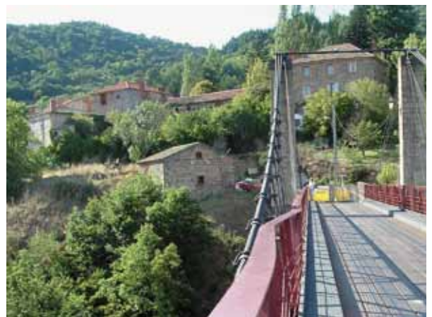
Figure 7 - Cas d'un ouvrage défectueux : pont suspendu présentant une déformation de la membrure supérieure d'une poutre (Photo : Sétra)
