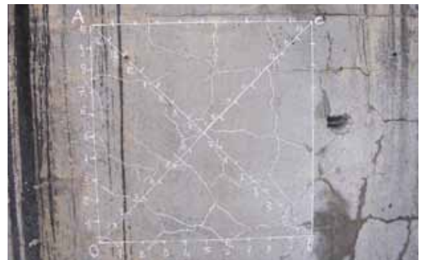
Figure 12 - Parement de béton atteint d'alkali réaction (Photo : LRCP de Saint-Brieuc)
