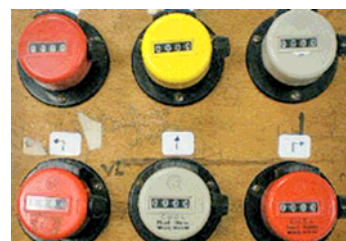
Compteurs mécaniques sur planchette
