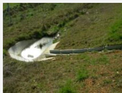
Illustration 15 : raccordement descente d'eau vers fossé servant d'exutoire par une cuvette béton en pied. Élément technique pouvant avoir un impact paysager non négligeable (Côté de l'Ouest)
