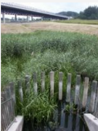
Illustration 14 : exutoire avant rejet dans le milieu naturel. Colonisation végétale du fond du bassin ayant à la fois un intérêt paysager et un rôle épuratoire (Côté Méditerranée)
