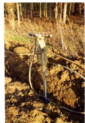
Photo 10 : Fixation au marteau-piqueur des poteaux de maintien - Source : J. Carsignol (Cete de l'Est)
