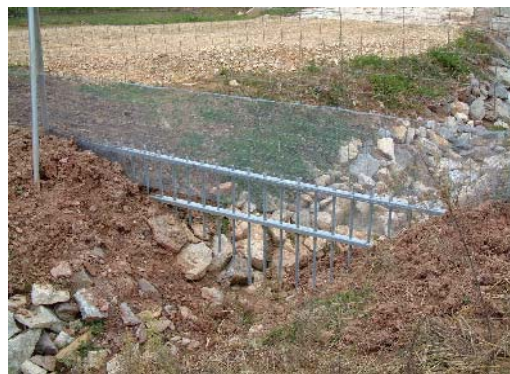
Photo 8 : Grille de blocage de la faune. Le treillis petite faune n'a aucune efficacité sur le foss ; il est disposé ainsi pour une facilité de mise en œuvre - Source : Sétra
