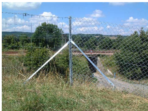
Photo 7 : Succession de treillis (soudés puis simple torsion) pour faciliter le raccordement à un ouvrage (pont, passage à faune,...) - Source : Sétra
