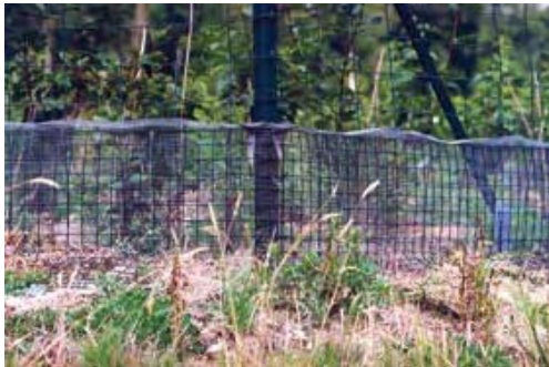
Photo 5 : Grillage soudé de type 6 adossé à la clôture grande faune de type 3. La partie supérieure est recourbée pour empêcher les animaux d'escalader et la partie inférieure est brochée au sol ou légèrement enterrée - Source : J. Carsignol (Cete de l'Est)
