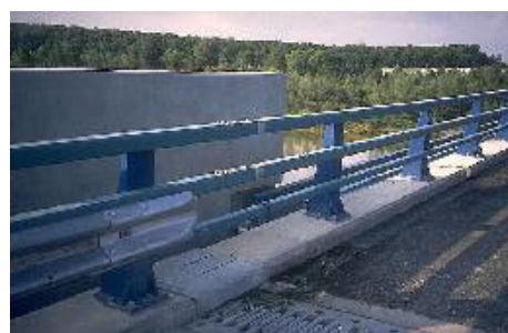
Barrière de sécurité de niveau H (photo Sétra/CTOA)
