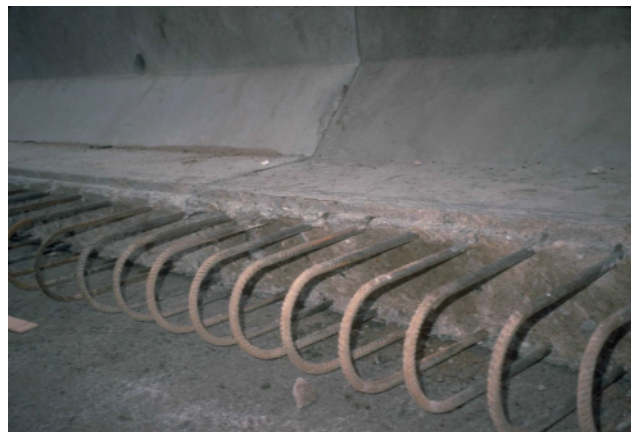
Zone de reprise de bétonnage (Photo Sétra/CTOA)
