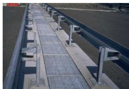
Barrière de sécurité de niveau N (photo Sétra/CTOA)
