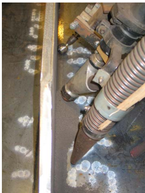
Préparation pour un soudage en bout avec le procédé automatique sous flux en poudre (photo CETE Est)
