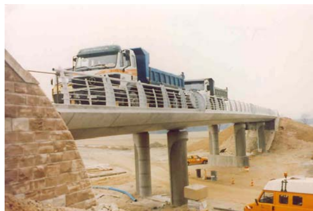
Chargement d'appui d'un pont-dalle (photo LRPC de Strasbourg)
