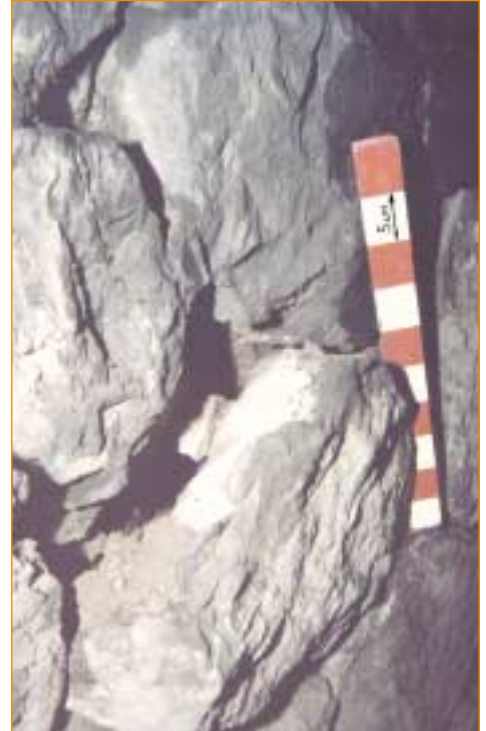
Décomposition totale d'un mortier amorceur la ruine du piedroit. Le facteur aggravant est ici l'absence d'assise des moellons opus
