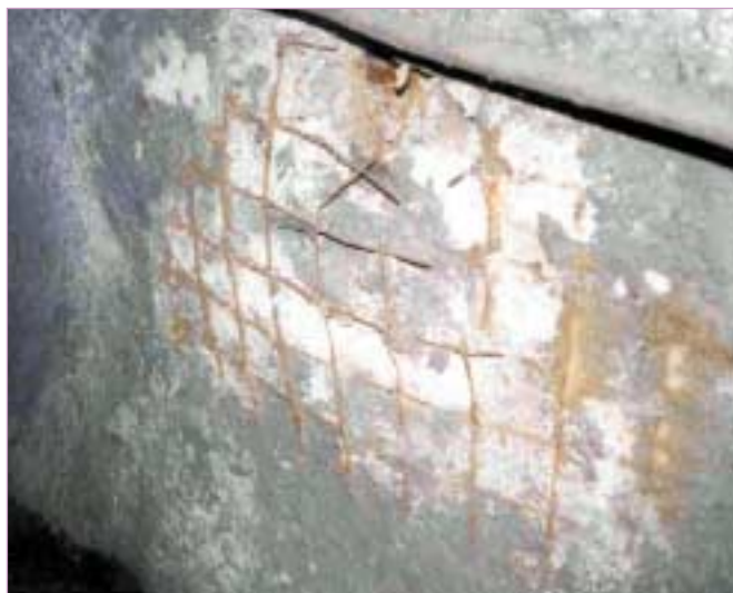
Le treillis soudé n'a pas reçu un recouvrement suffisant (malfaçon)
