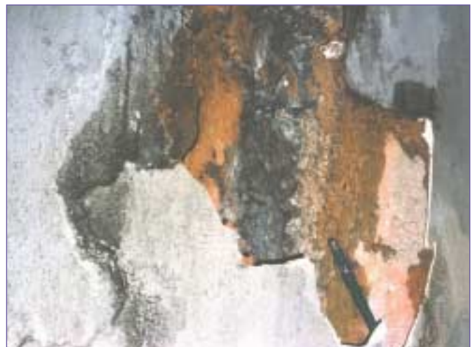
Éclatement d'un cuvelage sous l'effet du gel
