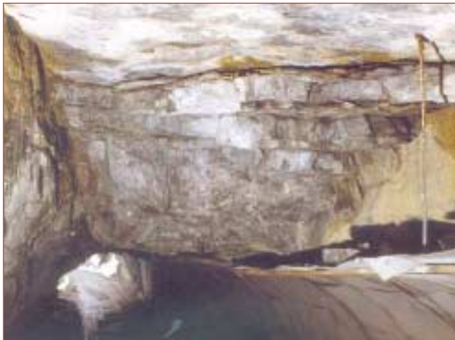
Le bloc tombé sur les tôles indique l'affaiblissement de l'extrémité d'une strate calcaire. La présence de deux discontinuités verticales et humides sur les côtés constitue une situation potentiellement dangereuse à long terme pour l'ensemble de la partie rocheuse centrale
