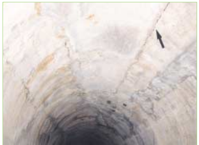
Fissure longitudinale en béton coffré liée à une déformation du revêtement sous la poussée du terrain encaissant. La fissure s'exprime le long d'une reprise de bétonnage
