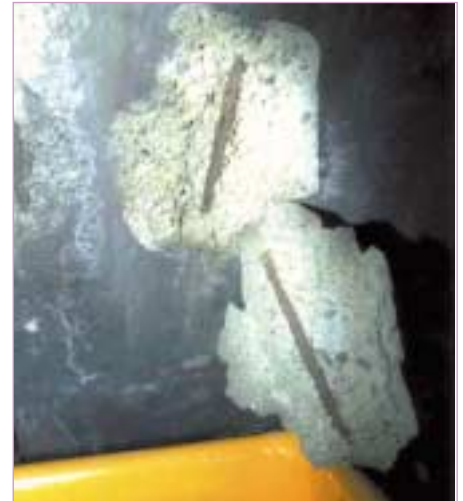
Une armature de fort diamètre peut décoller une écaille de 2 à 3 cm d'épaisseur (béton de 1963)
