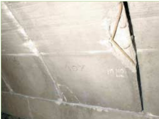
Un élément préfabriqué mince est épaufré par un choc (traces de frottements)
