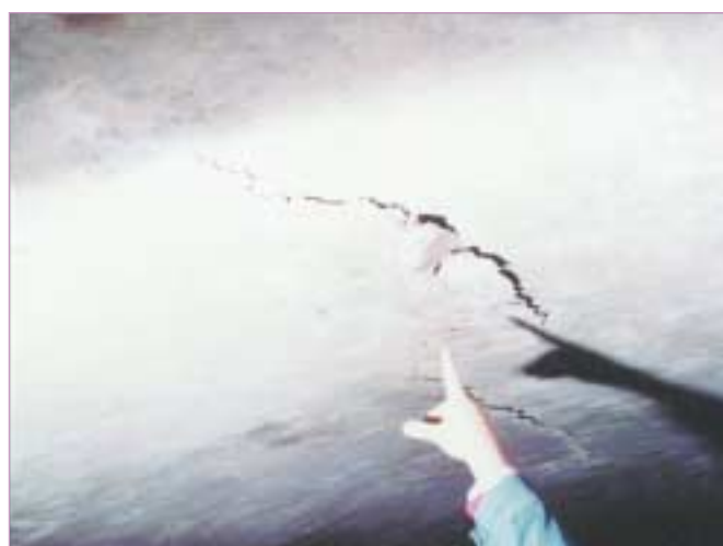
Début de cisaillement du béton en clé. La fissure cisailante (type 2) est ici nettement exprimée ; la lèvre est fragile
