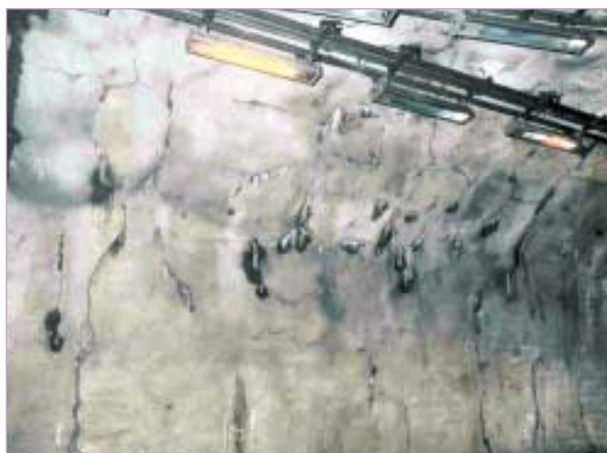
Faïençage d'un béton projeté sur rocher humide
