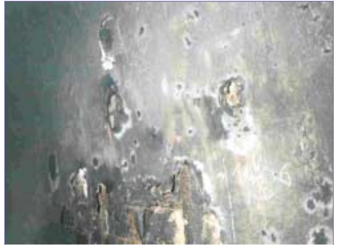
Dégradation d'un film de résine posé sur maçonnerie
