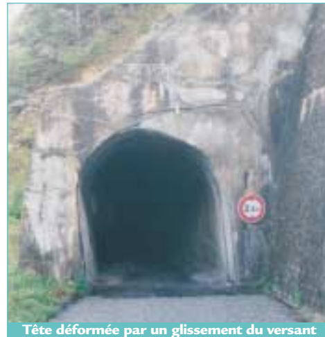
Tête déformée par un glissement du versant
