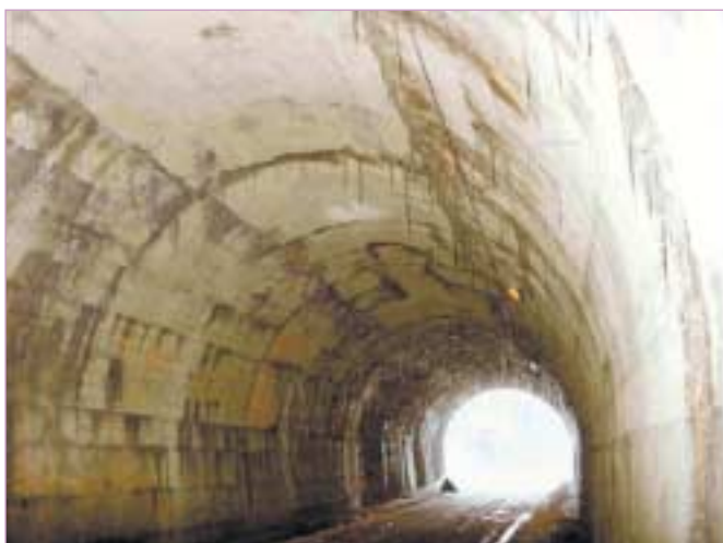
Béton de 1936. Chaque montée de béton est soulignée par un alignement de nids de cailloux, perméable et parfaitement horizontal dû à la mise en place
