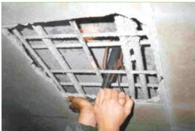
Fenêtre de reconnaissance ouverte sur une zone sonnant fortement le creux. Vide extradados de 27 cm par défaut de bétonnage
