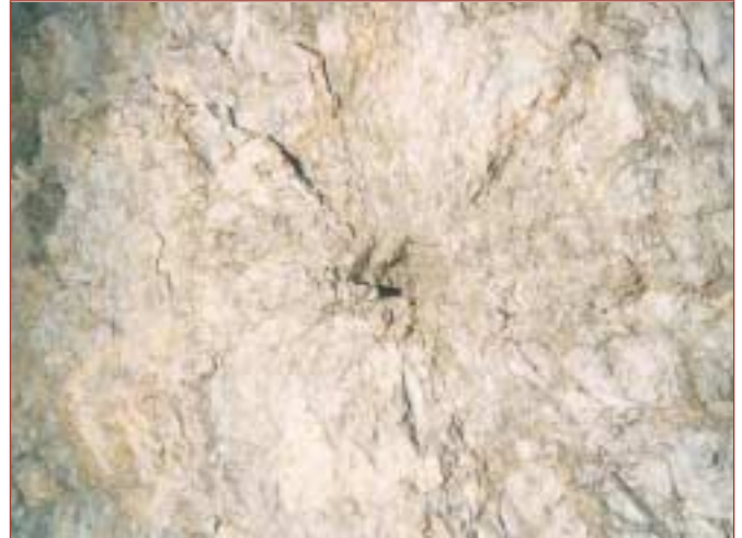
Calcaire dérocté au début du siècle. On distingue les fractures rayonnantes autour du forage de tir; l'ensemble de la roche est désorganisé et instable
