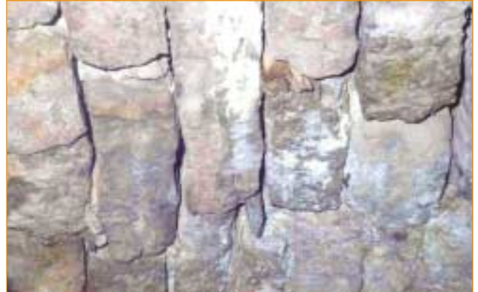
Déjointoiement par dissolution, typique d'un manque d'entretien. Les cales en bois étaient probablement destinées à sécuriser un moellon ou à stopper d'anciennes arrivées d'eau ponctuelles. Les moellons, pourtant de bonne qualité, sont quasiment déchaussés
