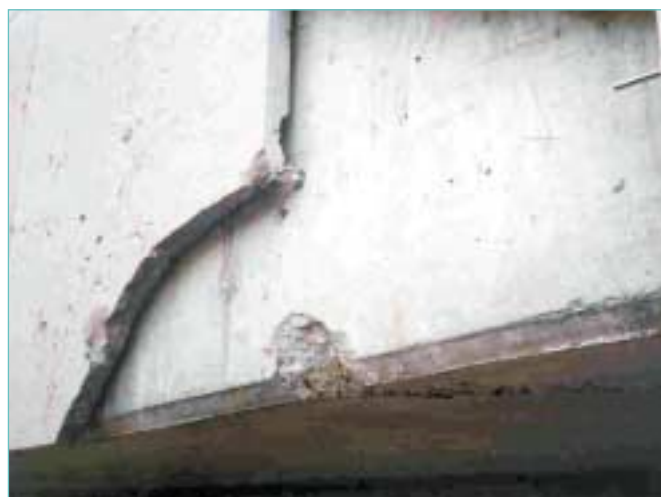
Rupture d'un habillage due à un choc de poids-lourd
