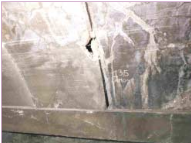
L'élément central est percé par un choc (traces de frottements). La fissuration est importante. L'extrados des éléments n'est pas bloqué au terrain (vide visible)
