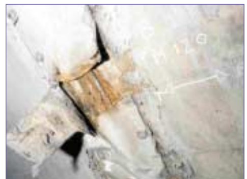
Les frottements de poids-lourds peuvent détruire le pontage et le joint amovible sous-jacent (ici, joint PRT et pontage Hypalon)
