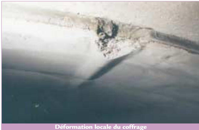
Déformation locale du coffrage
