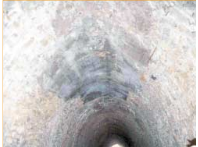
Le pincement de clé, déjà réparé en béton coffré (ancien), se poursuit par écrasement des moellons de clé
