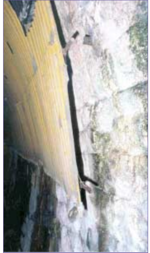
On note la perte d'un élément métallique, ainsi que la rupture des ancrages
