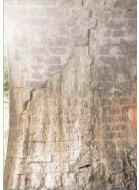
Fissure transversale couplée à une fissure oblique
