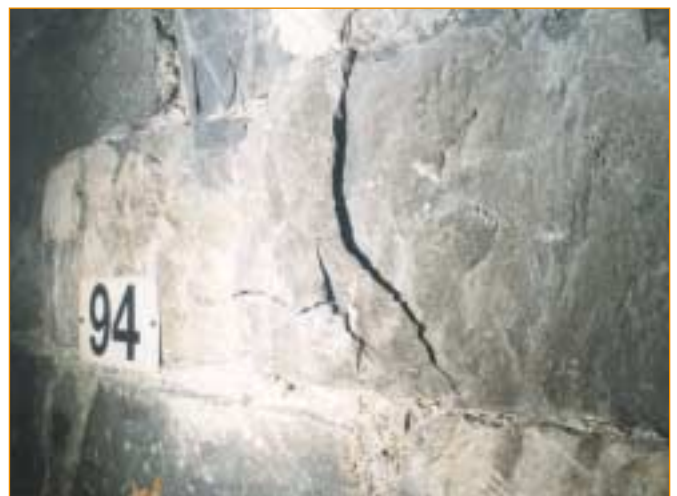
Écaillage de moellons en piedroit
