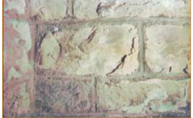
La maçonnerie de moellons gréseux a subi un rejointoiement, déjà ancien, à l'aide d'un mortier riche en ciment et compact, qui a vraisemblablement accéléré, sinon initié le processus de desquamation, en déplaçant les transferts d'eau dans la pierre
