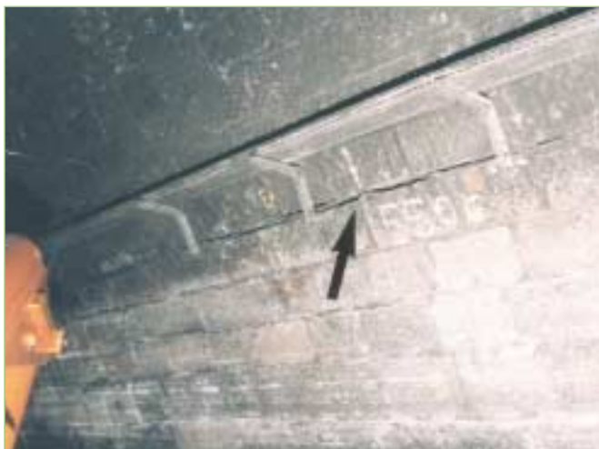
Fissure longitudinale consécutive à une déformation de la maçonnerie (méplat) attestée par les traces de frottement des véhicules. Le mortier est toujours présent sur une lèvre de la fissure
