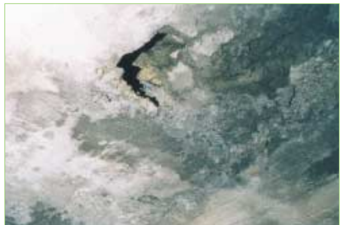
Vide d'origine à l'extrados d'un béton très altéré. Le revêtement sonnant creux est instable autour de l'ouverture
