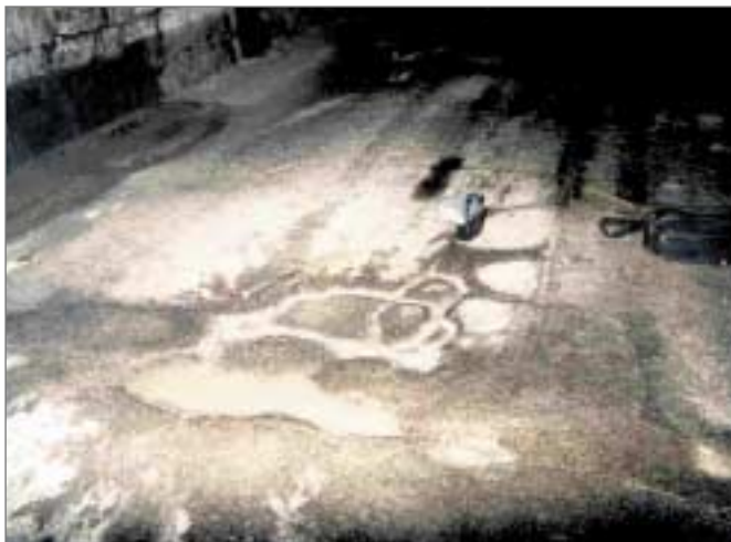
Faïençage, pompage et flaches Fondation saturée d'eau et comportant des vides de dissolution
