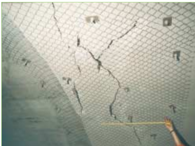
Rupture d'une voûte en béton coffré armé sous l'action de sollicitations trop élevées
