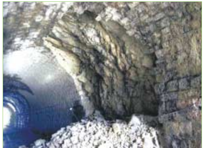
La moitié de la voûte est tombée par écrasement du piédroit, constitué de moellons très exfoliés et peu résistants. La ruine s'était annoncée par un ventre du piédroit, non conforté à temps. Le terrain n'était pas en cause.
