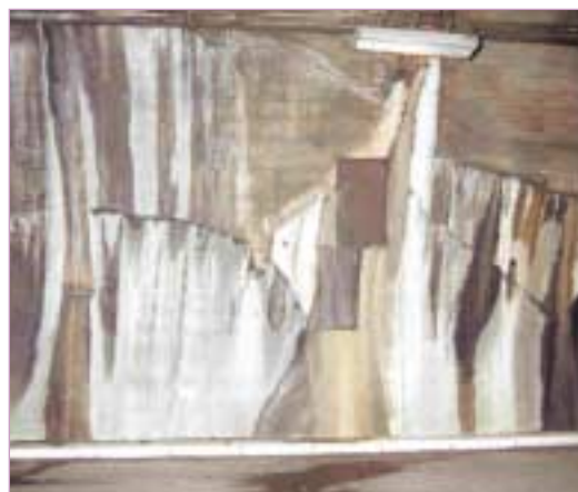
Expressions du retrait au sein d'un béton de 1970 sans étanchéité extrados
