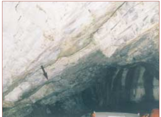
Plaques décollées inclinées de 45° en rein de tunnel
