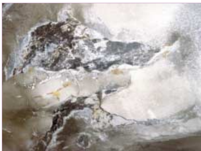
Béton projeté tombé en calotte. Conjugaison d'une projection mal conduite, sur un terrain schisteux, humide et instable, soumis au gel prolongé
