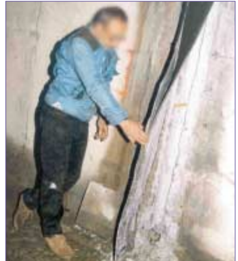
Le pontage est décollé, la base du captage est détruite par le gel et engorgée
