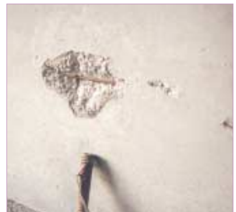
Éclatements dans un béton récent
