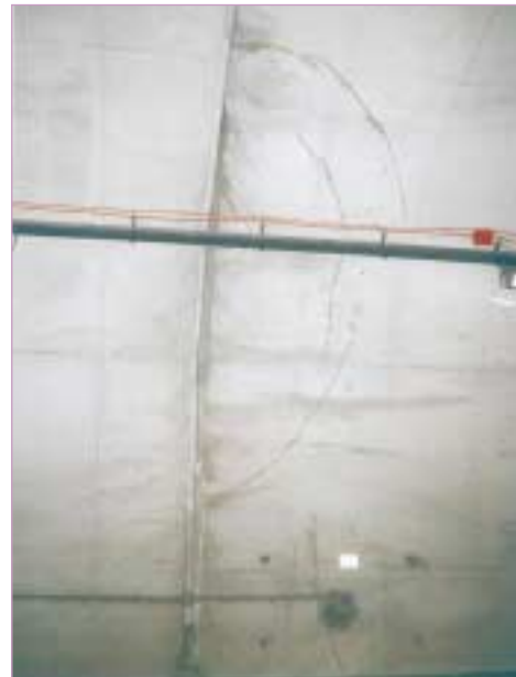
Lunules imbriquées en rein (la base de la photo correspond au trottoir). Le bétonnage s'est fait de la droite vers la gauche
