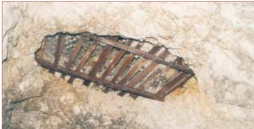
Karst rempli de matériaux mal consolidés Protection contre les chutes de matériaux par IPN
