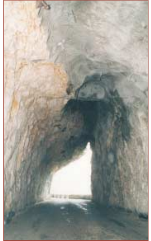
Instabilités résiduelles dans la zone de l'alésage latéral
