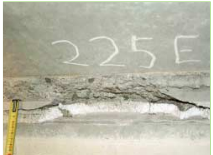
Épaufrure à la base de l'appui d'une dalle de ventilation, survenue probablement lors du décoffrage. À gauche, subsiste une écaille non encore tombée
