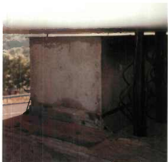
Fig. 6.21 - Détail d'une boîte à sable ouverte
