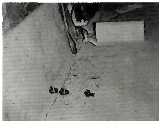
Fig. 8.3 - Fissure de poussée au vide à la jonction âme hourdis
