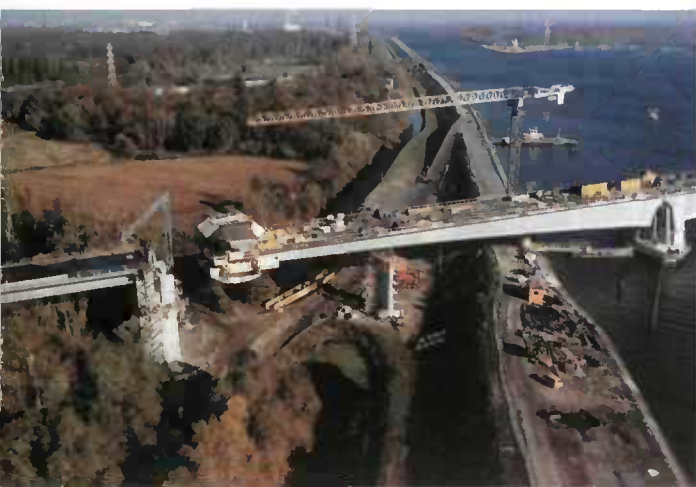
Fig. 6.18 - Construction à l'équipage et avec palée provisoire du tronçon d'extrémité d'une travée de rive
