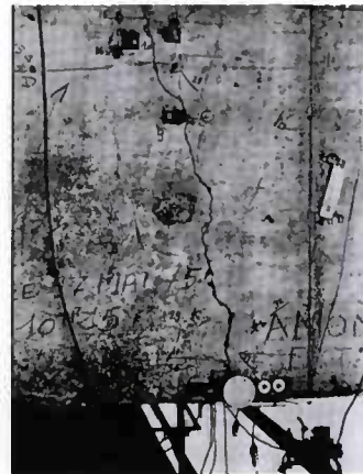
Fig. 8.2 - Fissures de flexion
