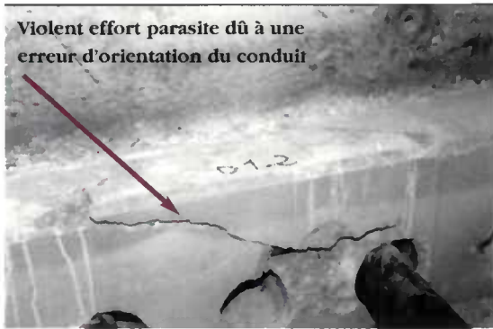
Fig. 7.16 - Éclatement d'un déviateur à la mise en tension
