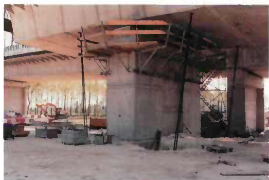
Fig. 5.8 - Stabilité par câbles extérieurs d'une pile dont le chevêtre est de trop petite taille
