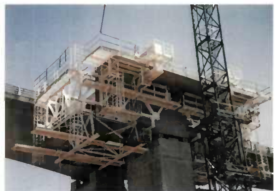
Fig. 6.3 - Vue générale d'un équipage mobile
