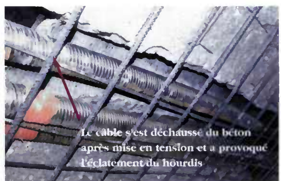
Fig. 7.15 - Éclatement du hourdis inférieur/Vue de biais par-dessous
