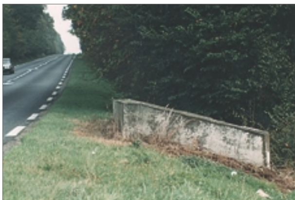
Cette tête de ponceau faisant saillie constitue un véritable mur sur l'accotement
