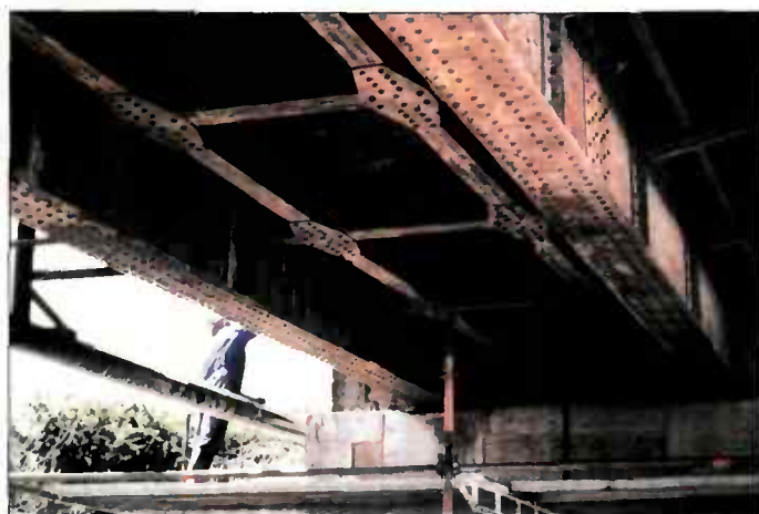
Fig. 5 - Cas d'un ouvrage en état quasi normal : pont métallique présentant un enrrouillement et nécessitant une remise en peinture.
