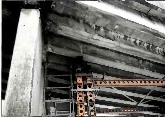
Fig. 21 Étatement passif pour prévenir la chute de quelques poutrelles précontraintes par armatures adhérentes fissurées à l'une de leurs extrémités.
