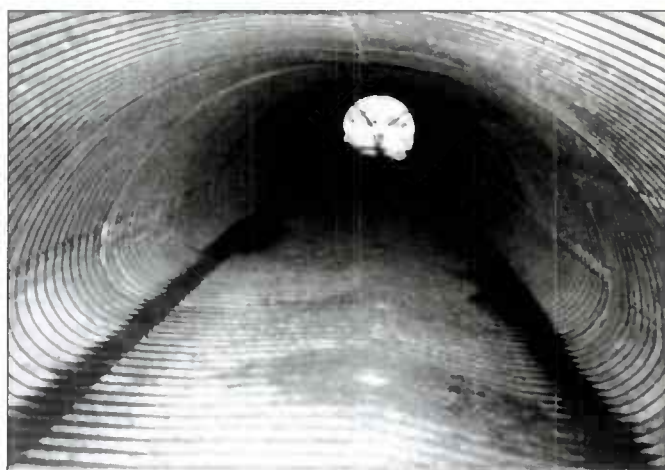
Fig. 1 - Buse métallique présentant un aplatissement et une inversion de courbure du radier mettant en cause la sécurité de l'ouvrage.
