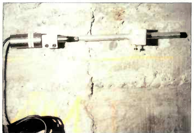
Fig. 15 : Suivi de l'ouverture d'un joint à l'aide d'un capteur de mesure de déplacement.
