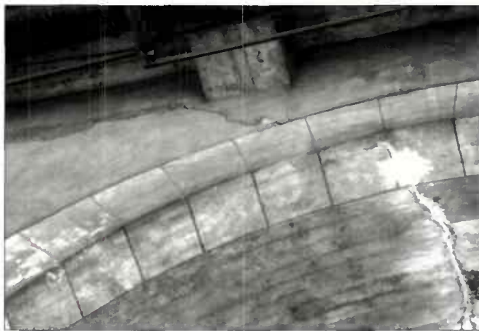
Fig. 6 - Cas d'un ouvrage défectueux : pont voûté en béton non armé fissuré.
