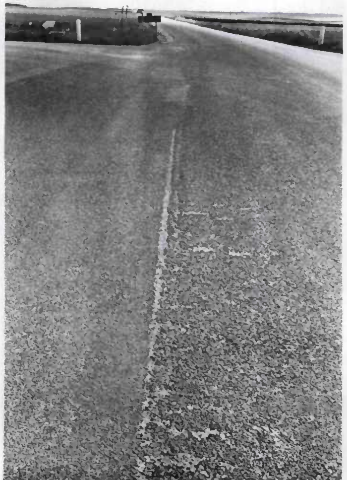
Défaut de recouvrement entre deux bandes de répandage.
