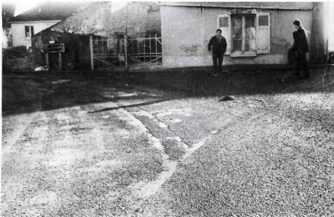
Arrachements de granulats dus à la topographie des lieux rendant nécessaire des reprises de répandage, et aux sollicitations tangentielles élevées (basculement des granulats).
