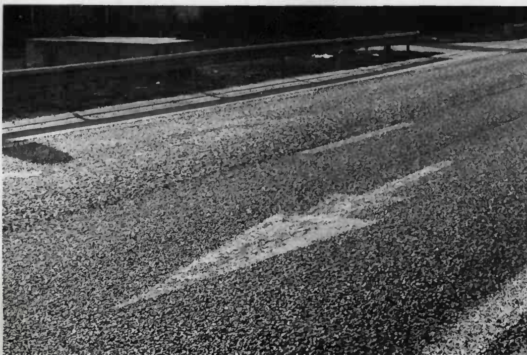
Ressuage très localisé causé par l'ancienne signalisation horizontale (enfoncement des granulats dans le matériau de marquage).
