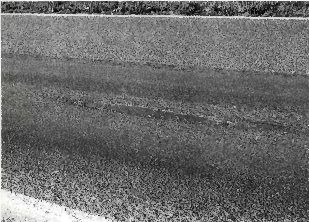
Détérioration de l'enduit frais consécutive à un coup de frein brutal.
