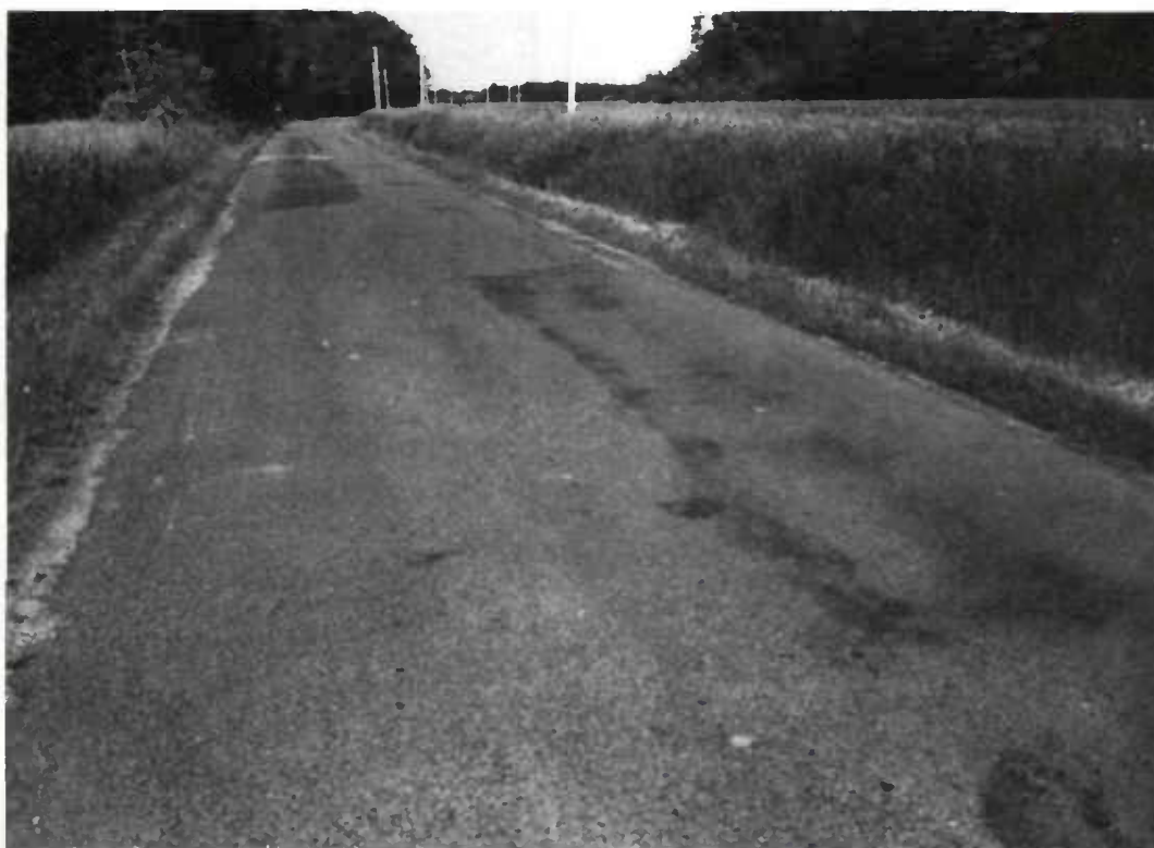
Ressuages localisés se produisant au niveau des travaux de préparation du support.
