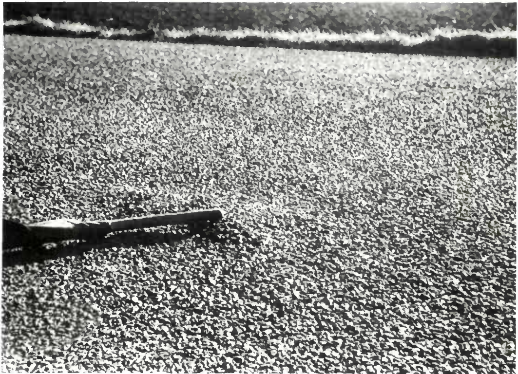
Surépaisseur provenant d'un surdosage en liant et granulats.
