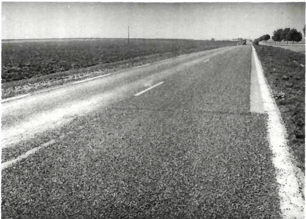
Défaut en rive, consécutif à une mauvaise trajectoire de la répandeuse.
