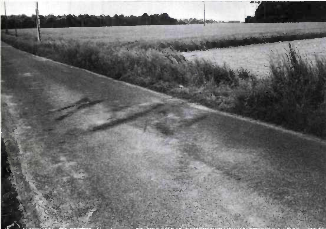
Détérioration localisée de l'enduit à la suite de manœuvres d'un engin agricole en sortie de culture.
