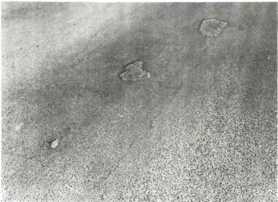
Pelades très localisées (nettoyage insuffisant du support).
