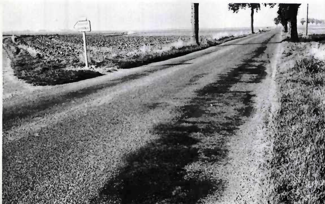
Ressuage dû à un surdosage généralisé en liant.
