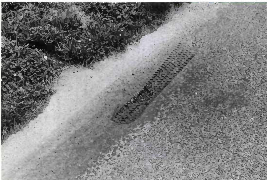
Ressuage et arrachement de l'enduit en rive.
