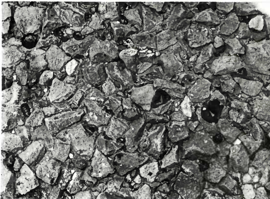
Amorce de ressuage par extrusion d'une partie du liant après densification de l'enduit.
