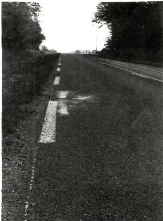
Ressuage par accumulation de liant dans une flache.
