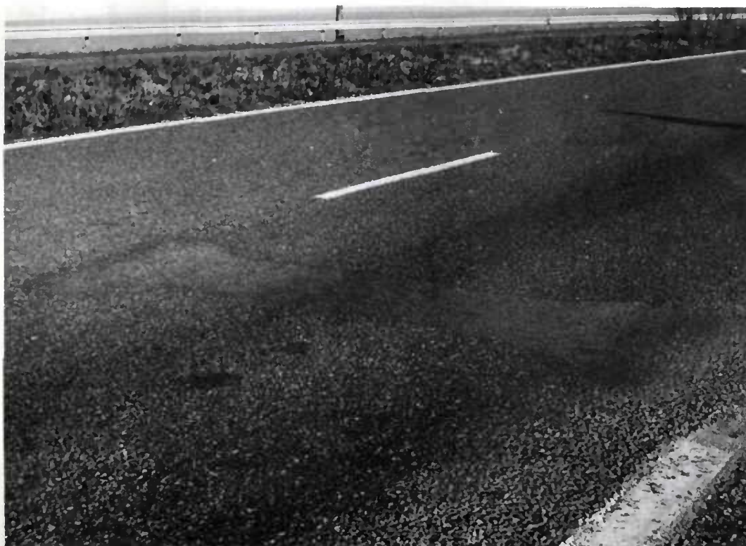
Ressuage à une reprise de répandage.
