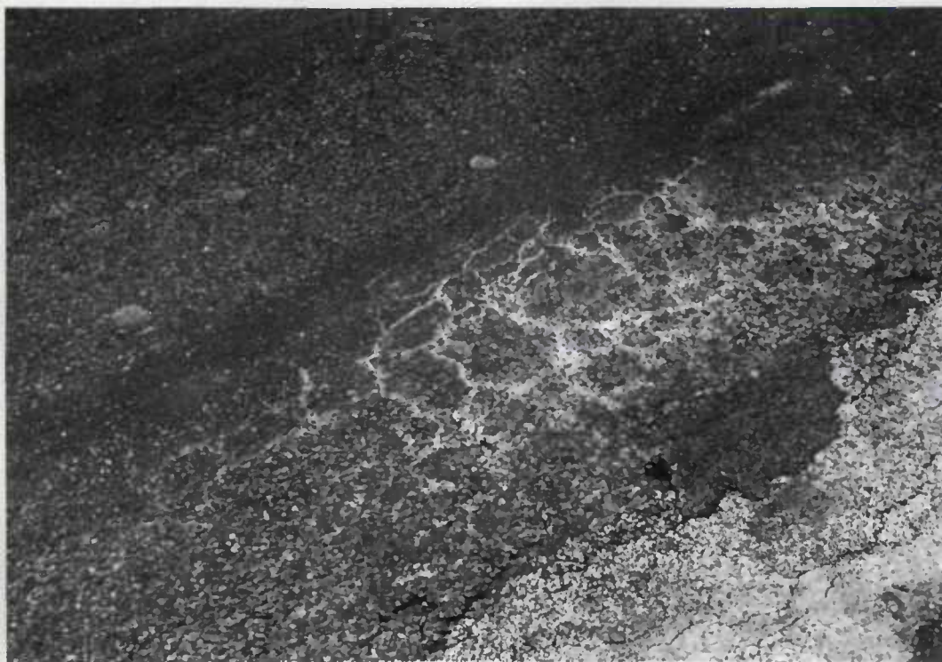
Dégradations en rive dues à la faiblesse des épaulements réalisés lors de l'élargissement de la chaussée.
