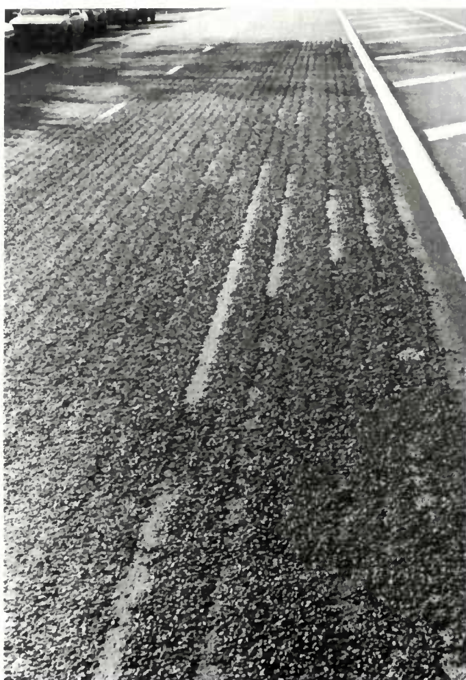
Peignage résultant d'une hauteur de rampe mal adaptée (mauvais recouvrement des jets au sol)
