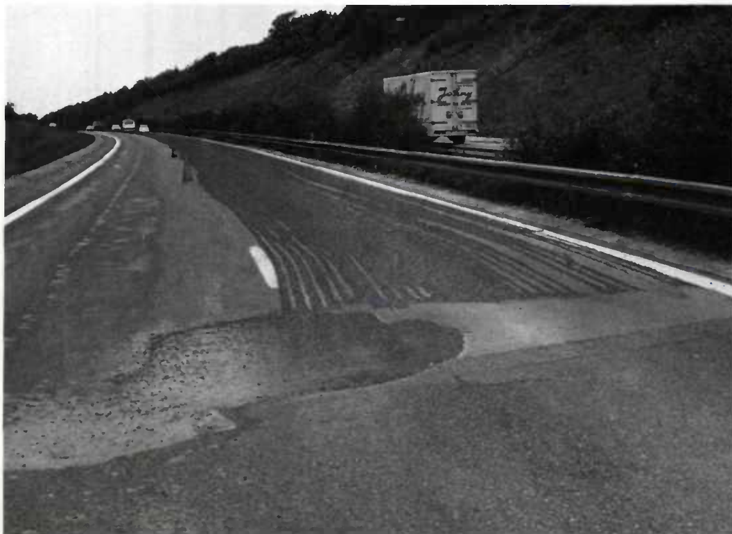
Nombreux défauts de réalisation
