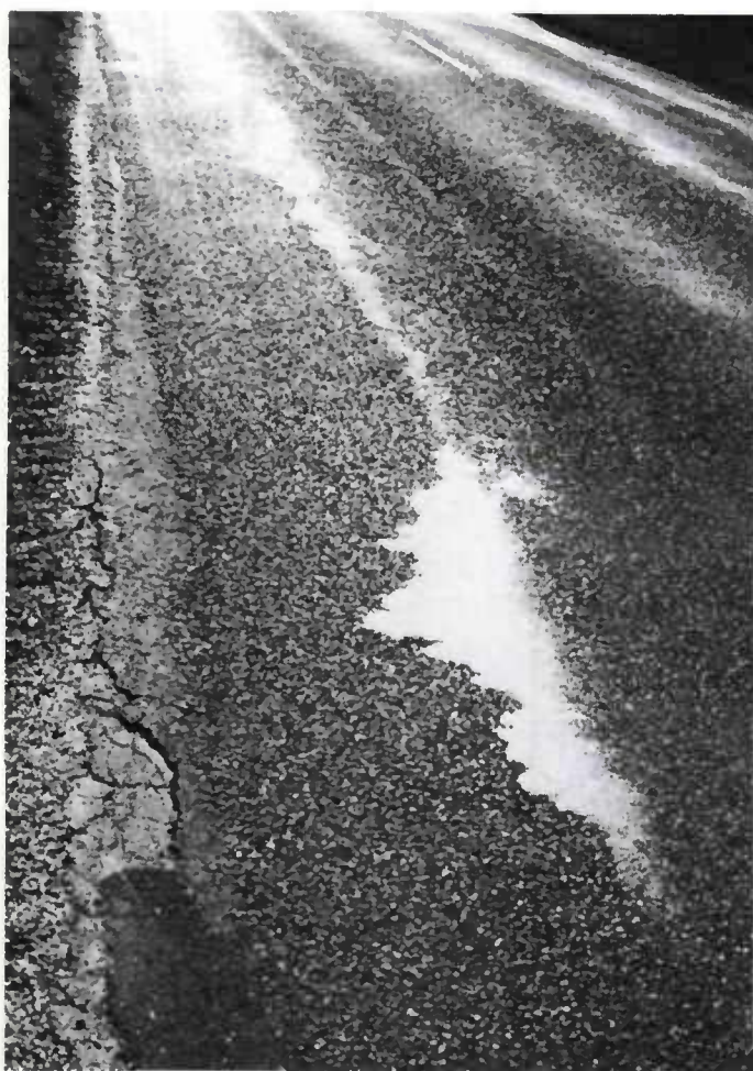
Défaut de répartition. Écoulement du liant en excès.
