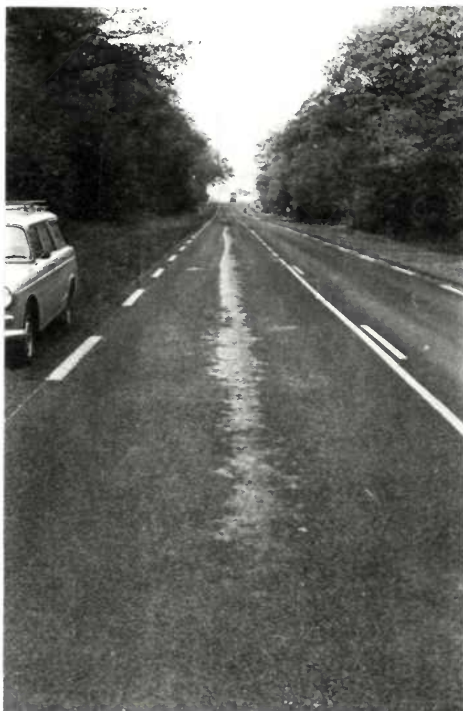
Arrachements de granulats dus à un sous-dosage entre traces (jet bouché).
