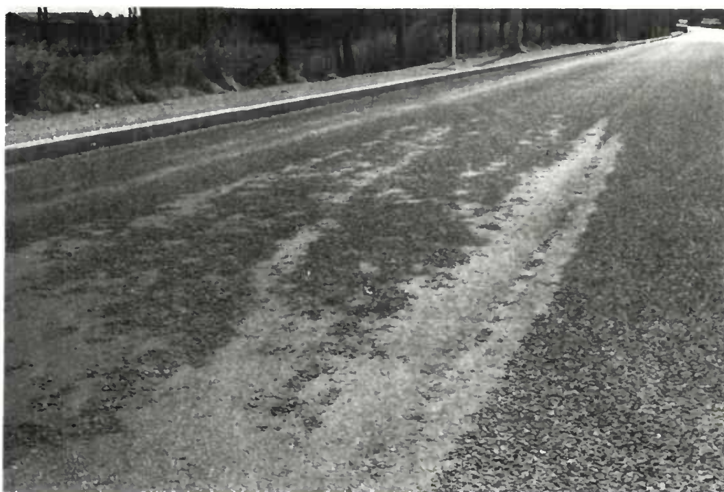
Plumage d'un enduit.
