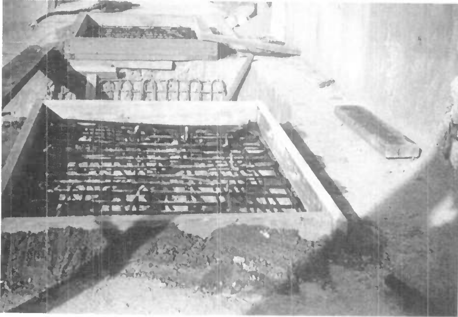
Photo n° 6 : Illustration de la méthode décrite au § 2.1.1. Coffrage , calage du coffrage et frettage d'un bossage inférieur .
