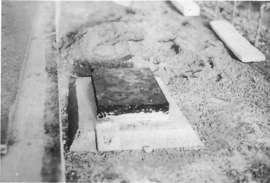
Photo n° 9 : Méthode de la boîte à sable : appareil d'appui sur son bossage et début de la mise en place du sable .
