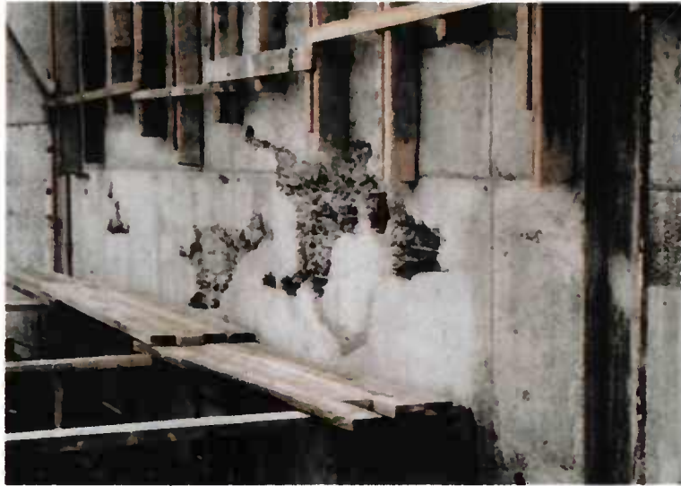
FIGURE 96 : Défauts de bétonnage
