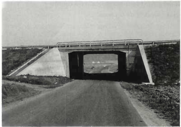
FIGURE 49 : Jonction en V entre piédroit et mur en aile. Disposition inesthétique à éviter.
