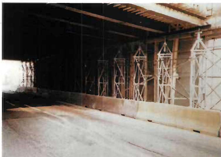
FIGURE 85 : Mise en place du coffrage de la traverse après exécution des piédroits
