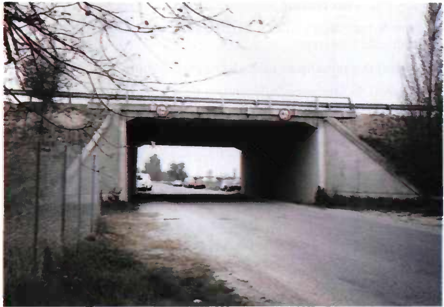
FIGURE 75 : Murs en aile avec revanche sous corni- che permettant un pro- longement de celle-ci
