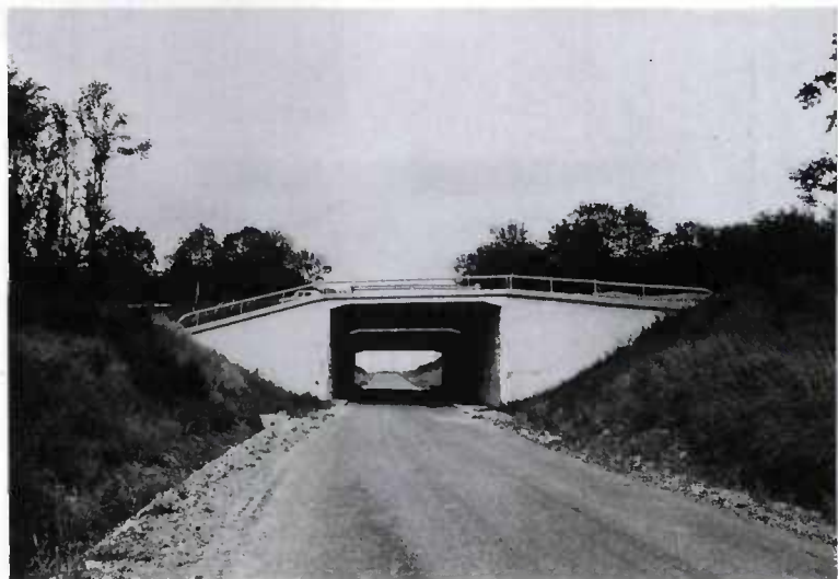
FIGURE 21 : Murs en retour inadaptés à la pente longitudinale de la voie portée
