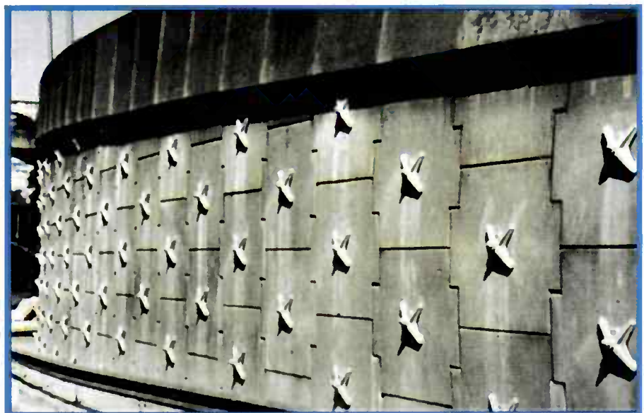
Figure B19 : Renforcement d'un mur en terre armée par clouage de chaque écaille
