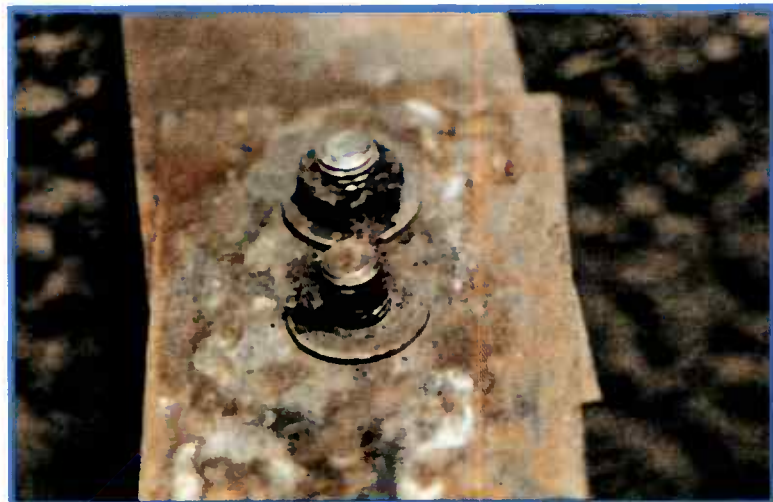
Figure A2 : Écrous en acier inoxydable corrodés
