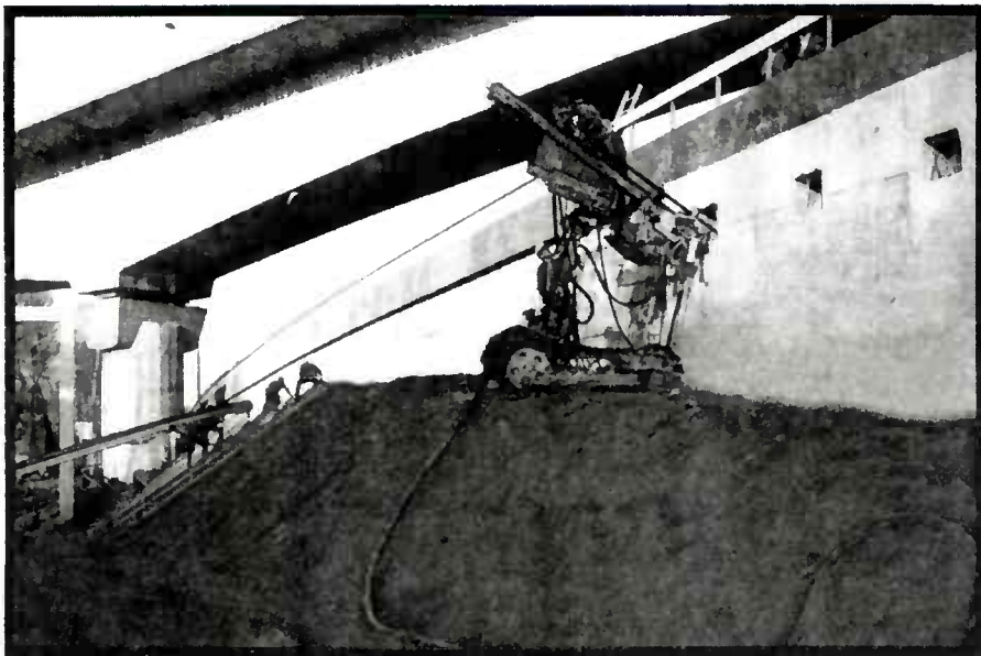
b - Réalisation des inclusions postérieure à celle du voile en béton armé
