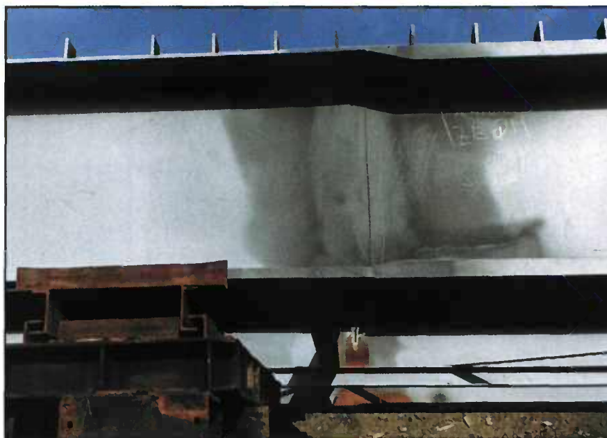
Photo 4 : Variation d'épaisseur excessive dans la semelle supérieure.
