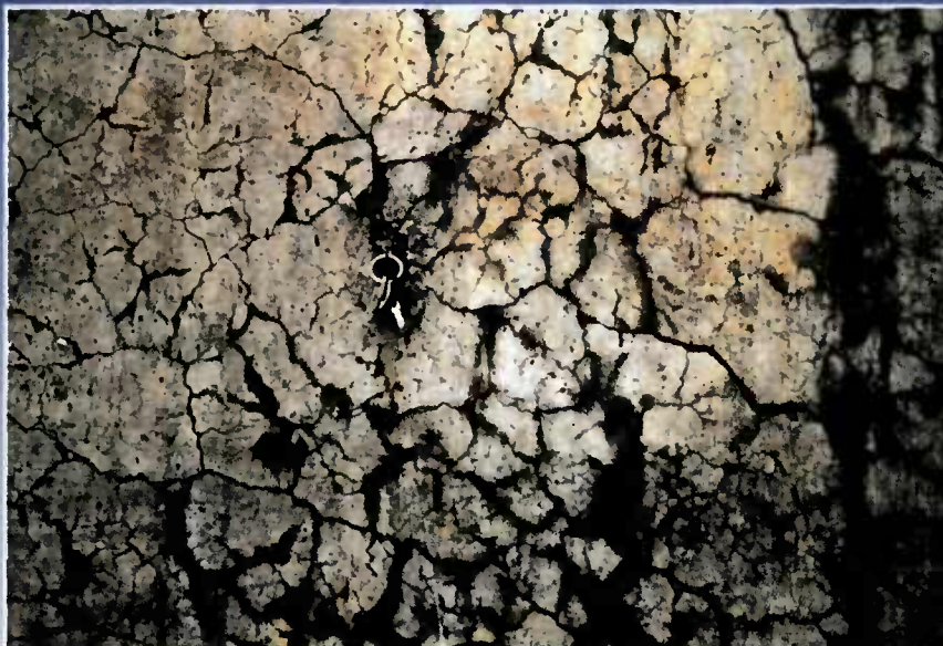
Réseau de fissures dû à l'alcali-réaction
