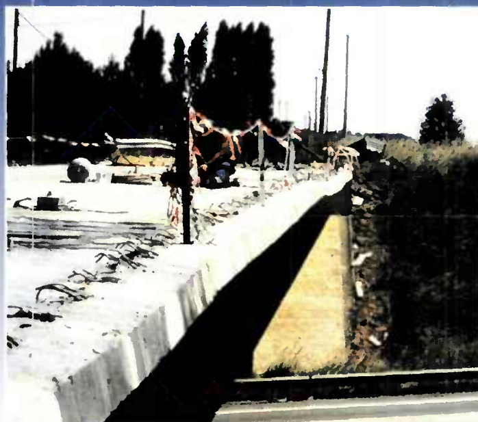
Déformation d'un tablier due à l'alcali-réaction
