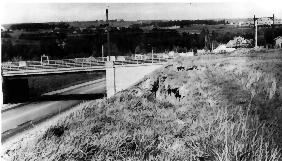
Fig. 10 — Glissements d'un talus de déblai mettant en jeu la stabilité d'une culée de pont.
