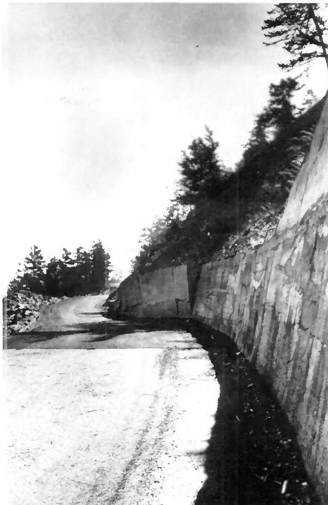
Fig. 17 — Désordres sur un mur de soutènement soumis à l'action d'un glissement de terrain.
