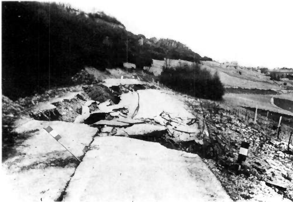
Fig. 2 — Glissement d'un talus de remblai sur versant.
