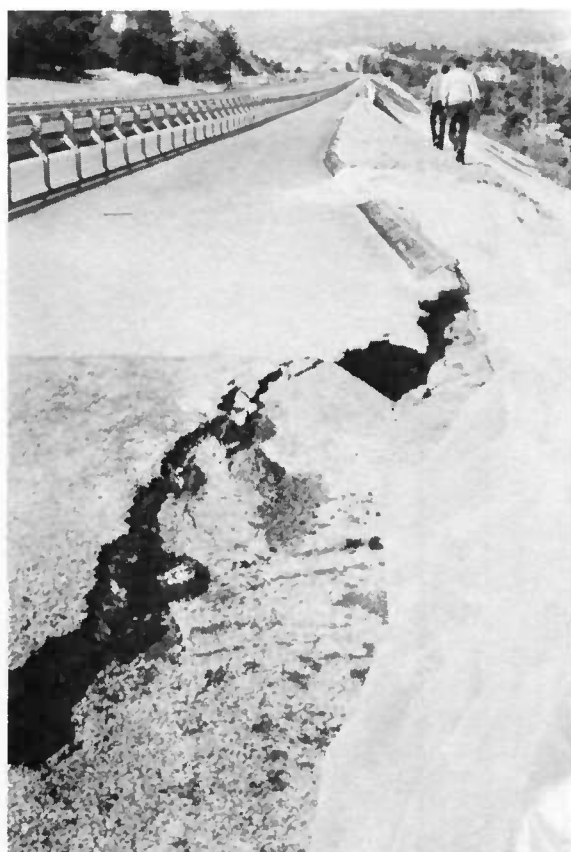
Fig. 16 — Fissuration de la chaussée traduisant un mouvement du sol en profondeur.
