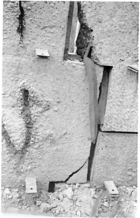
Fig. 8 — Rupture d'éléments de parement en béton.
