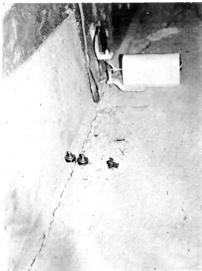
Fig. 35 — Exemple de fissures de poussée au vide.
