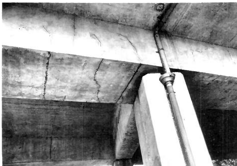
Fig. 14 — Exemple de fissuration dans un pont à nervures.
