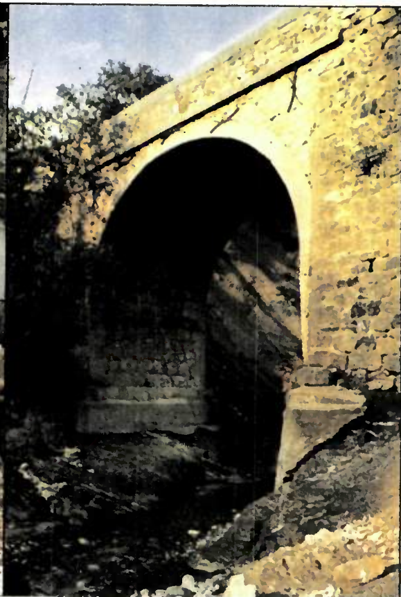
Affouillement de fondation
