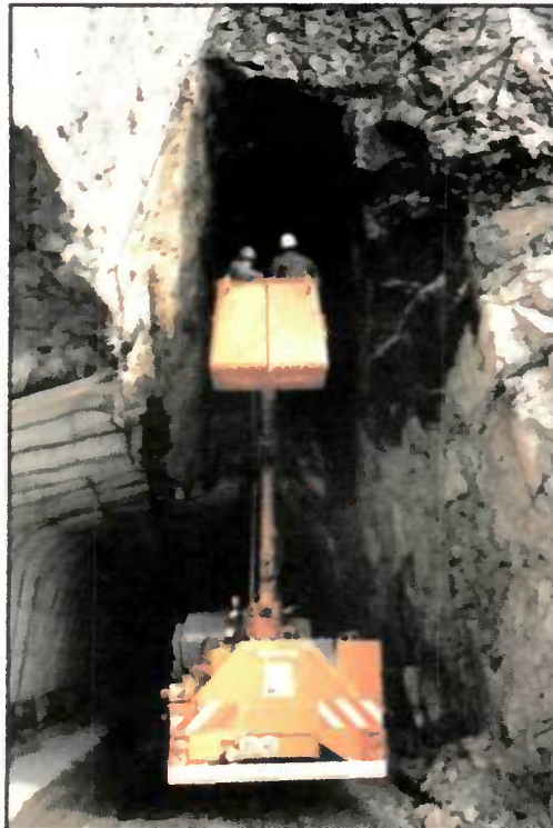
Centrale d'inspection des tunnels
