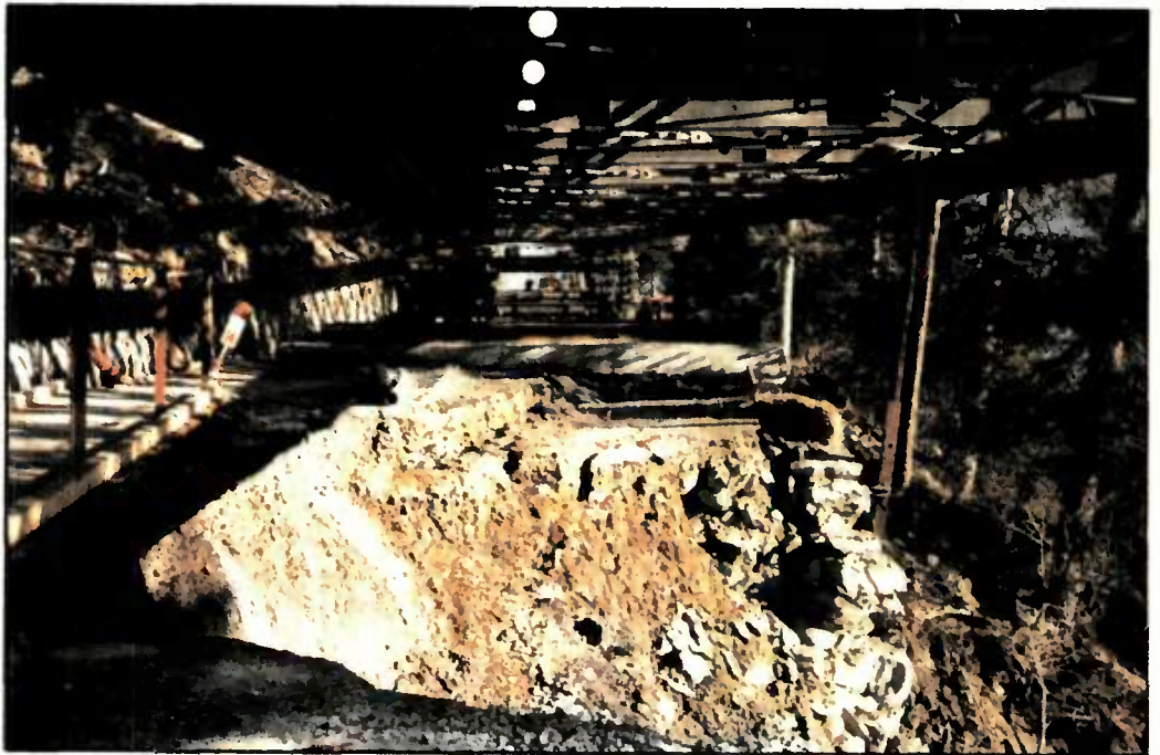
Rétablissement provisoire de la circulation à la suite de l'effondrement d'un mur
